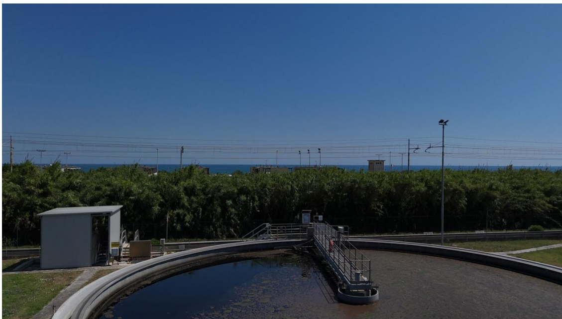
Impianto di trattamento delle acque (Punto di monitoraggio 3). Fonte: DJI Mini Pro 4
