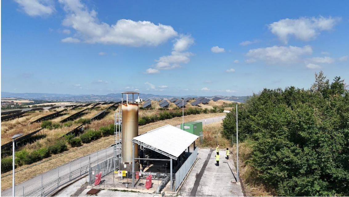
Stazione del biogas (Punto di monitoraggio 1)
