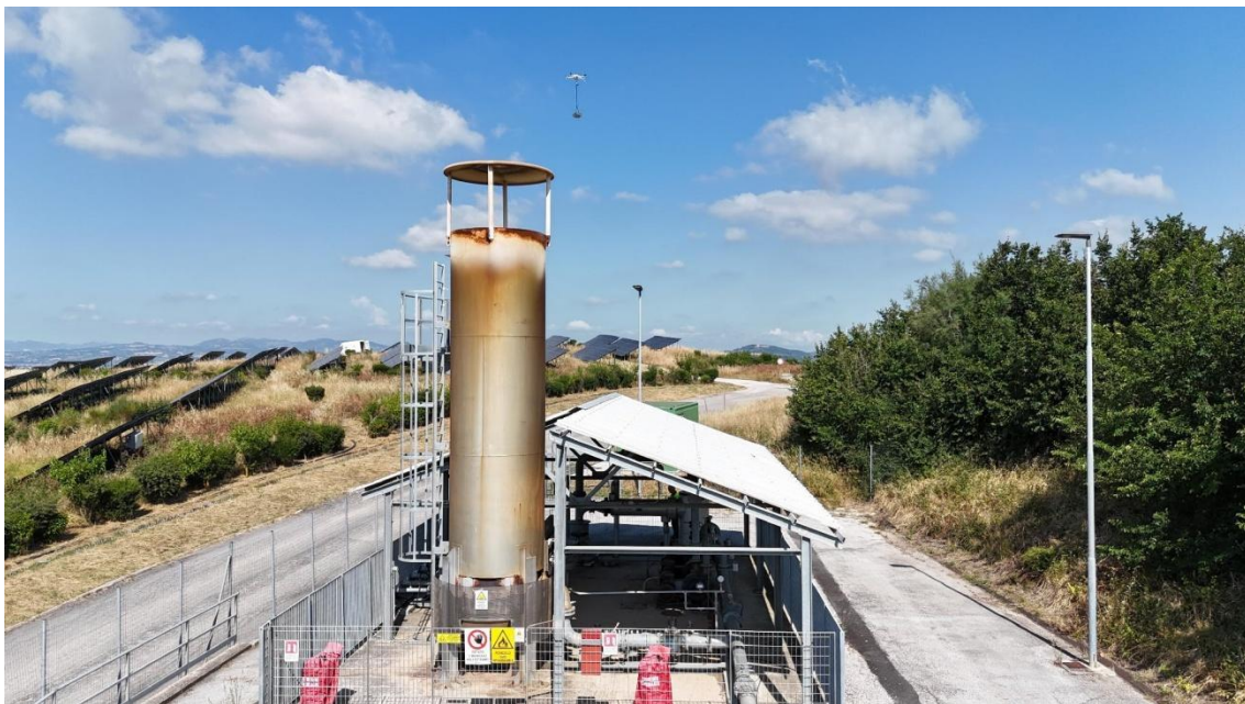
Stazione del biogas (Punto di osservazione 1) – Drone in hovering
