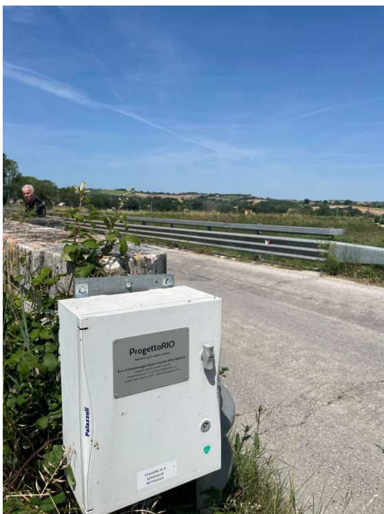
Stazione di monitoraggio del livello dell'acqua
