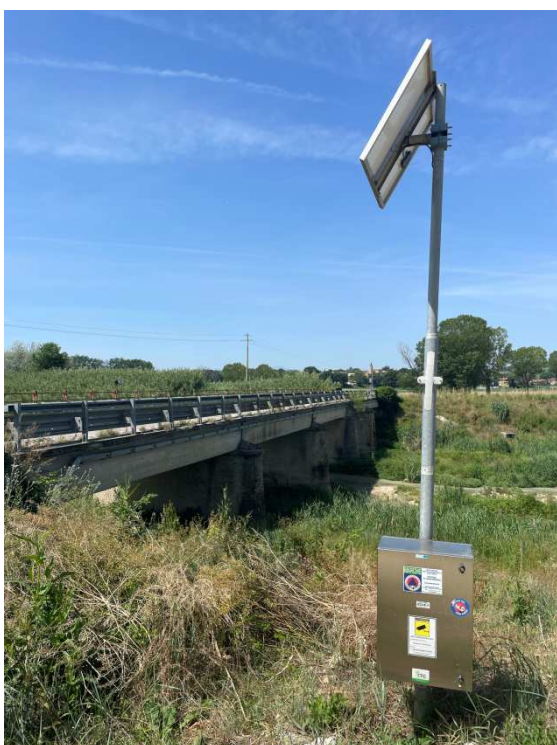
Stazione di monitoraggio del livello dell'acqua
