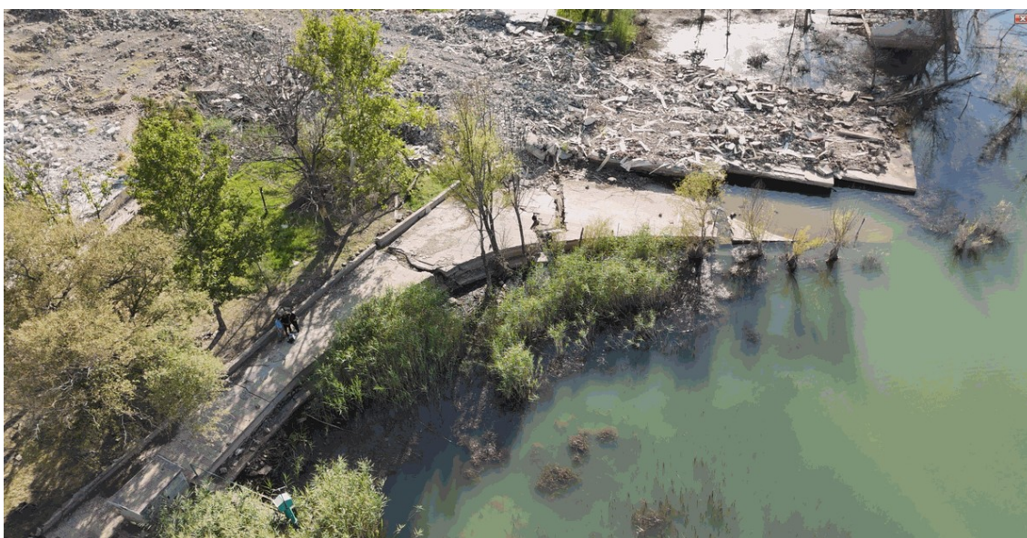
Figura 5. Vista obtida por drone que mostra o início do deslocamento do solo e a submersão parcial de uma zona pavimentada ao longo da margem do lago após um terremoto.
