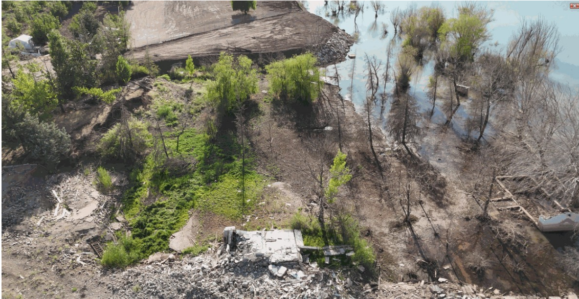
Figura 8. Vista oblíqua obtida por drone que mostra uma zona de deslocamento combinado de solo e vegetação após um terremoto.
