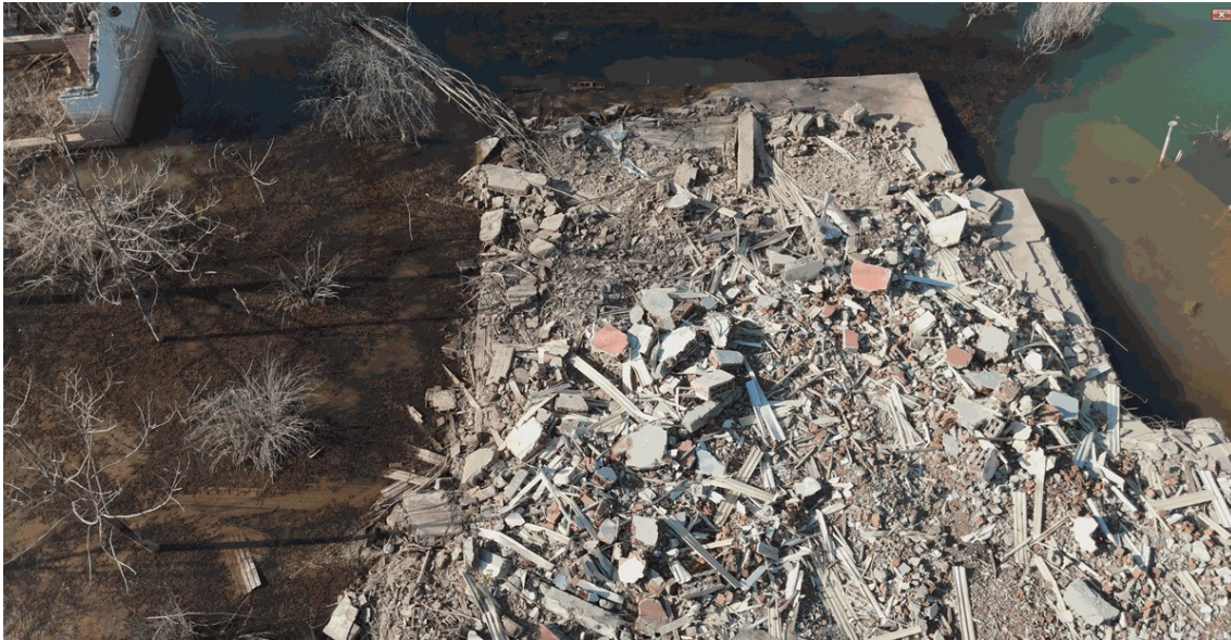
Figura 15. Vista detalhada da estrutura de betão armado colapsada e submersa junto à margem do lago, mostrando um movimento lateral acentuado do solo e falha das fundações.
