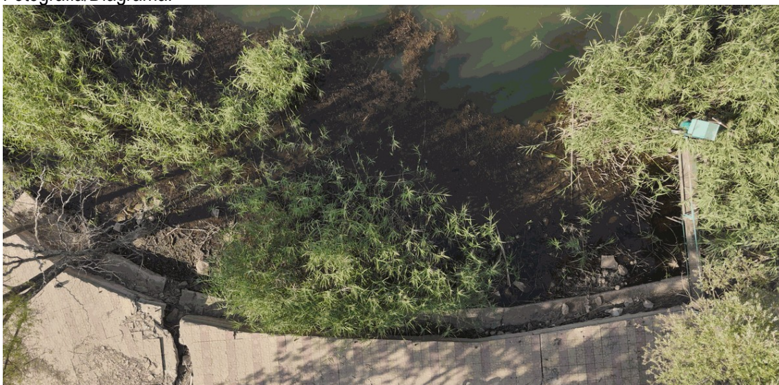
Figura 2. Vista vertical obtida por drone que mostra fissuração inicial e assentamento do terreno ao longo de um pavimento junto ao lago após um terramoto.
