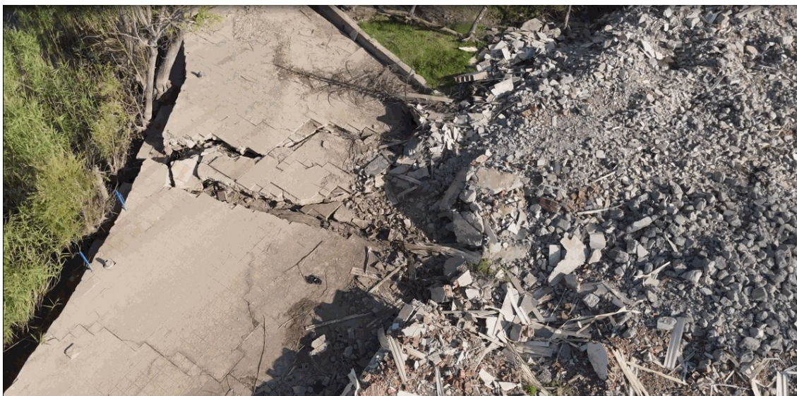
Figura 17. Muro de contenção deslocado e filas de árvores desalinhadas, indicando espalhamento lateral do solo e movimento diferencial do terreno em direção à margem do lago.
