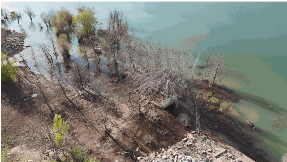
Figura 9. Vista obtida por drone que mostra pavimento colapsado junto ao lago, com rotação visível da superfície após um terremoto.
