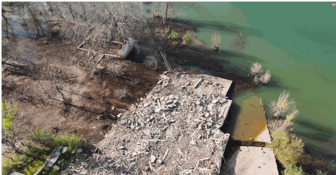
Figura 13. Estrutura colapsada junto ao lago, parcialmente submersa devido ao espalhamento lateral e ao deslocamento do solo.
