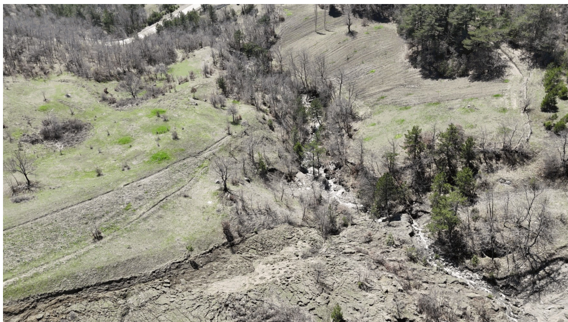
Figura 5. Vista oblíqua captada por drone, mostrando a interação entre o talude do deslizamento de terras e o curso de água adjacente. O escoamento canalizado e a erosão localizada no sopé ao longo do curso de água indicam processos de socavamento contínuos, enquanto o transporte
