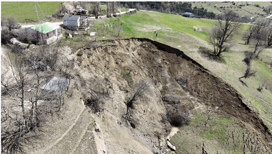
Figura 12. Vista ampla, obtida por drone, de um grande deslizamento de terras que afeta um talude próximo de estruturas residenciais, ilustrando a escarpa principal, a massa de solo deslocada e várias zonas de risco para a definição de prioridades de inspeção.
