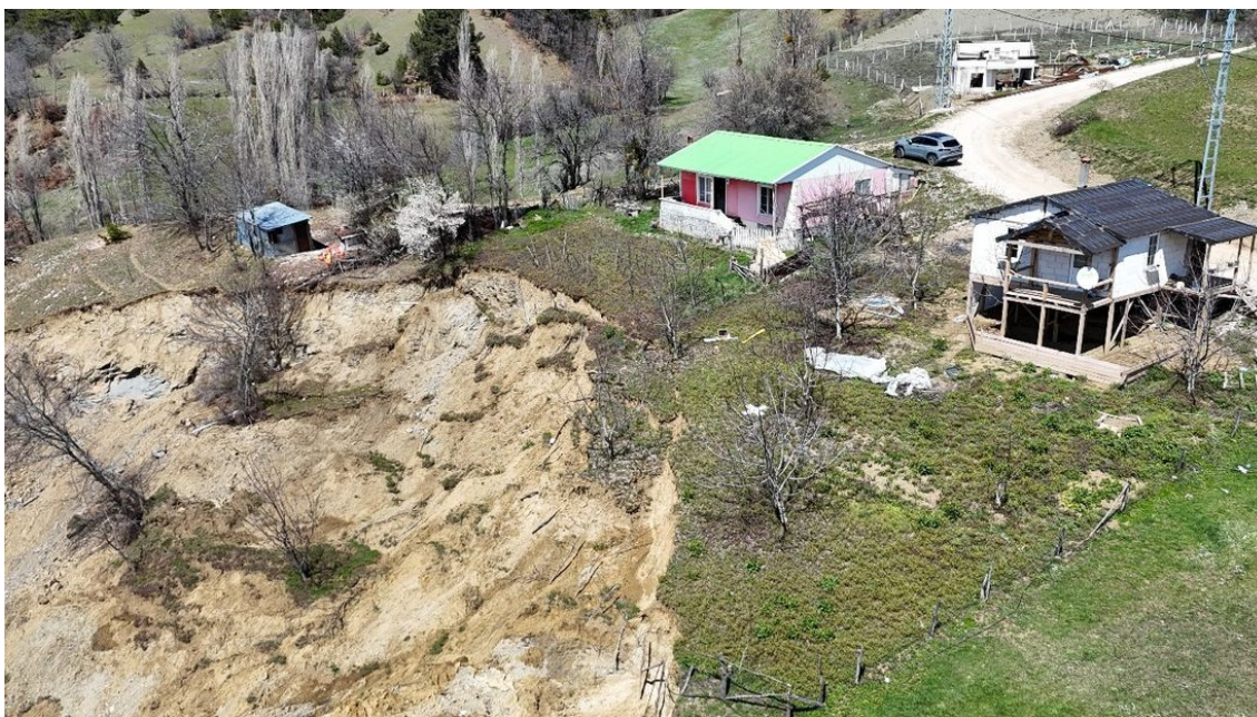
Figura 10. Vista aérea que mostra um deslizamento de terras ativo muito próximo de habitações, destacando zonas de risco elevado e o potencial impacto da instabilidade do talude nas estruturas próximas durante o processo de inspeção.
