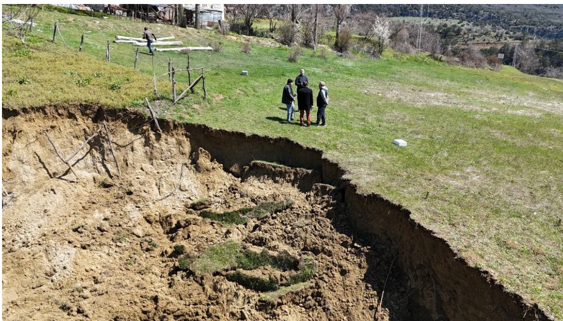
Figura 1. Vista ao nível do solo que mostra pessoas junto à extremidade de uma escarpa de deslizamento de terras ativa, ilustrando condições inseguras e a importância de manter distâncias seguras durante a inspeção.
