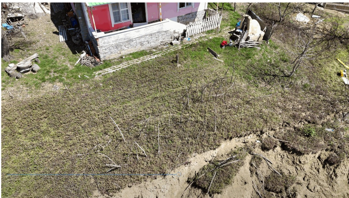
Figura 14. Vista aproximada, obtida por drone, que mostra deformação superficial e uma pequena rutura do talude perto de uma estrutura residencial, destacando instabilidade numa fase inicial e o risco potencial para os edifícios próximos.
