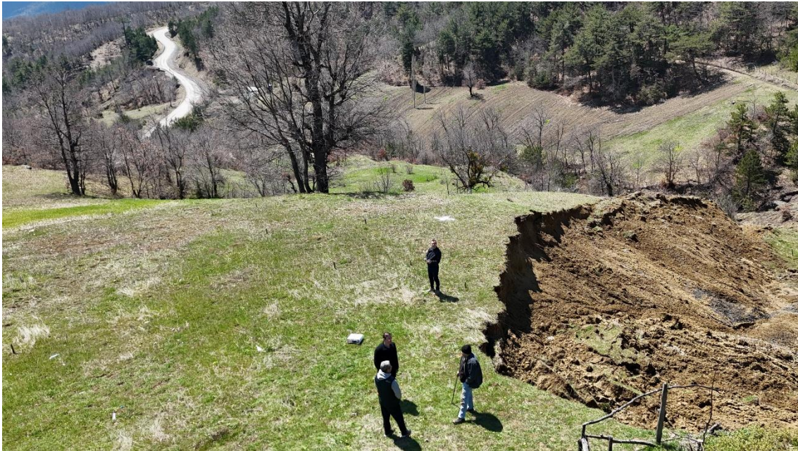
Figura 2. Vista generale di un'area franata che mostra una scarpata ripida e le condizioni del terreno circostante, illustrando zone potenzialmente pericolose e i rischi associati all'avvicinamento a terreni danneggiati dopo un terremoto.
