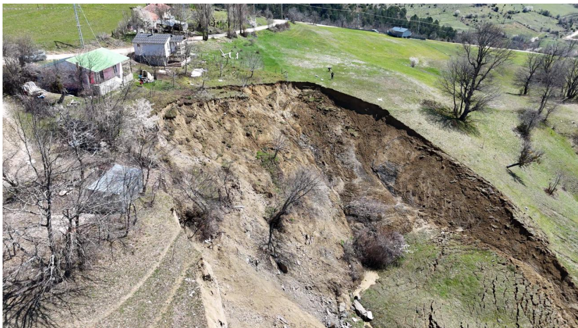
Figura 12. Vista su vasta area con drone di una grande frana che ha interessato un pendio vicino a strutture residenziali, che illustra la scarpata principale, la massa di terreno spostata e le molteplici zone a rischio per la definizione delle priorità di ispezione.
