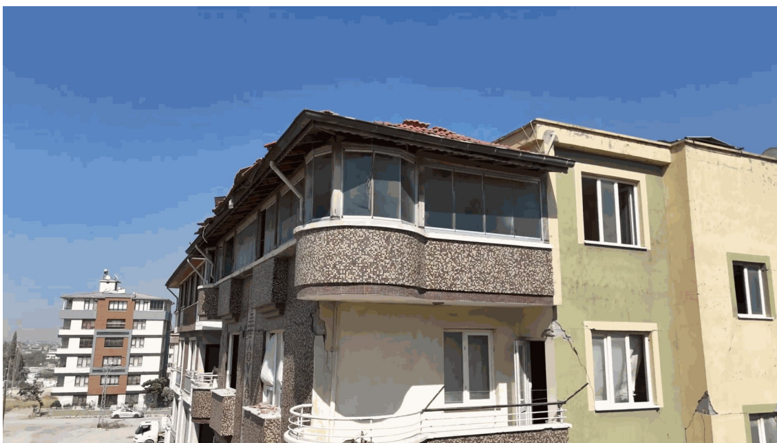
Figura 6. Vista oblíqua captada por drone que mostra a rotação da fachada e o desalinhamento da linha da cobertura em comparação com os edifícios vizinhos.
