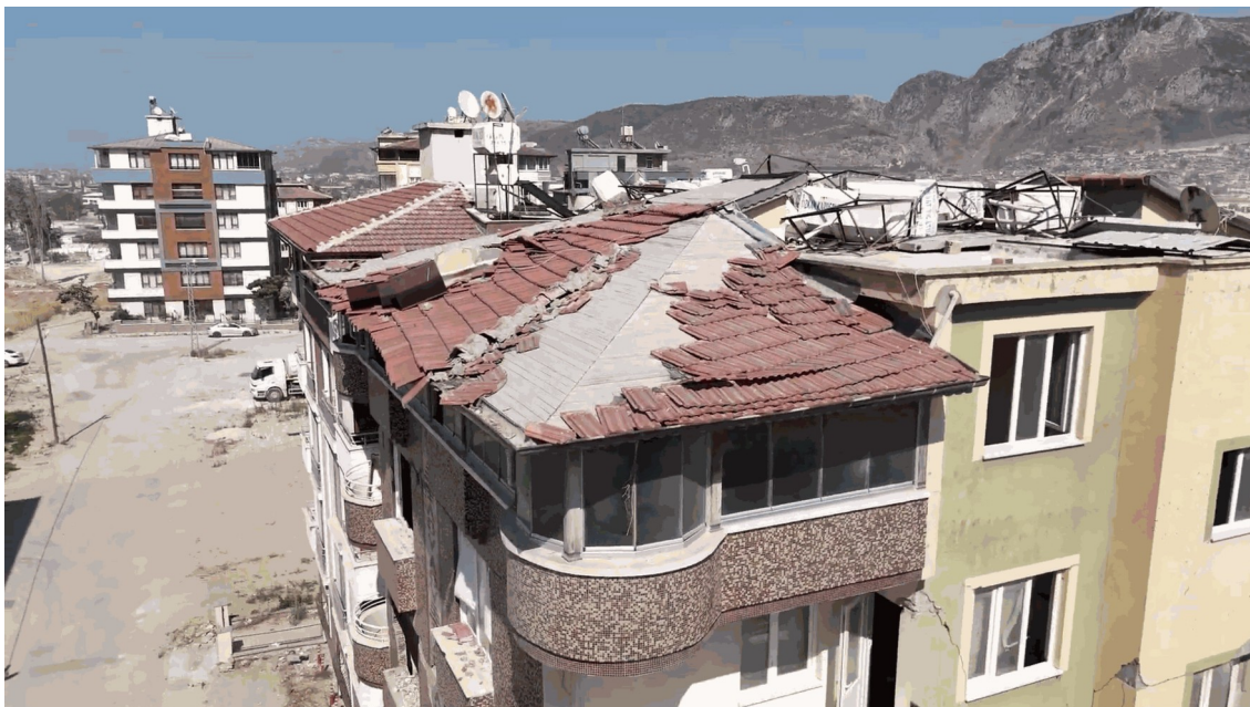
Figura 7. Vista ao nível da cobertura captada por drone que mostra telhas deslocadas e danos na parede de platibanda, indicando uma falha não estrutural e o perigo de queda de detritos.
