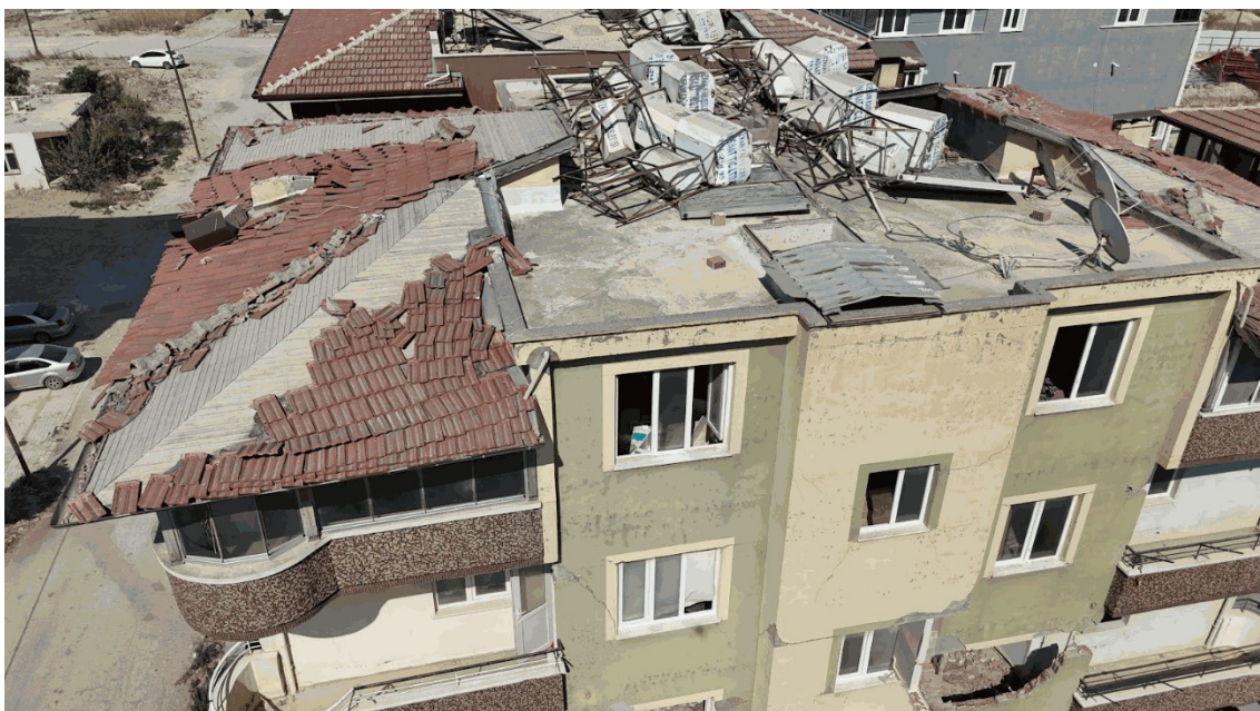
Figura 9. Imagem vertical captada por drone que mostra o gradiente de deslocamento da cobertura e a acumulação de detritos no terraço, indicando potenciais perigos de queda e danos não estruturais.
