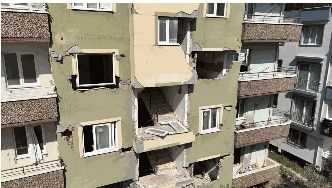
Figura 10. Vista da fachada posterior captada por drone que mostra a exposição da caixa de escadas e a falha das paredes de enchimento, enquanto a estrutura de betão armado permanece, em grande medida, intacta, indicando um desempenho estrutural correspondente ao nível de segurança de vidas.
