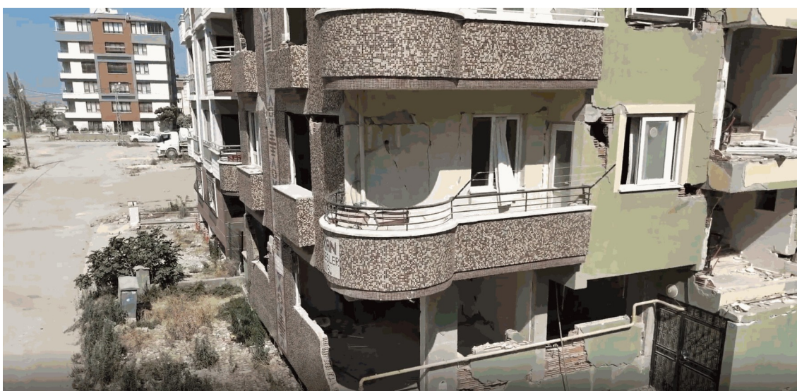
Figura 4. Vista lateral que mostra os efeitos dos danos por torção nos pilares de canto e nas varandas.
