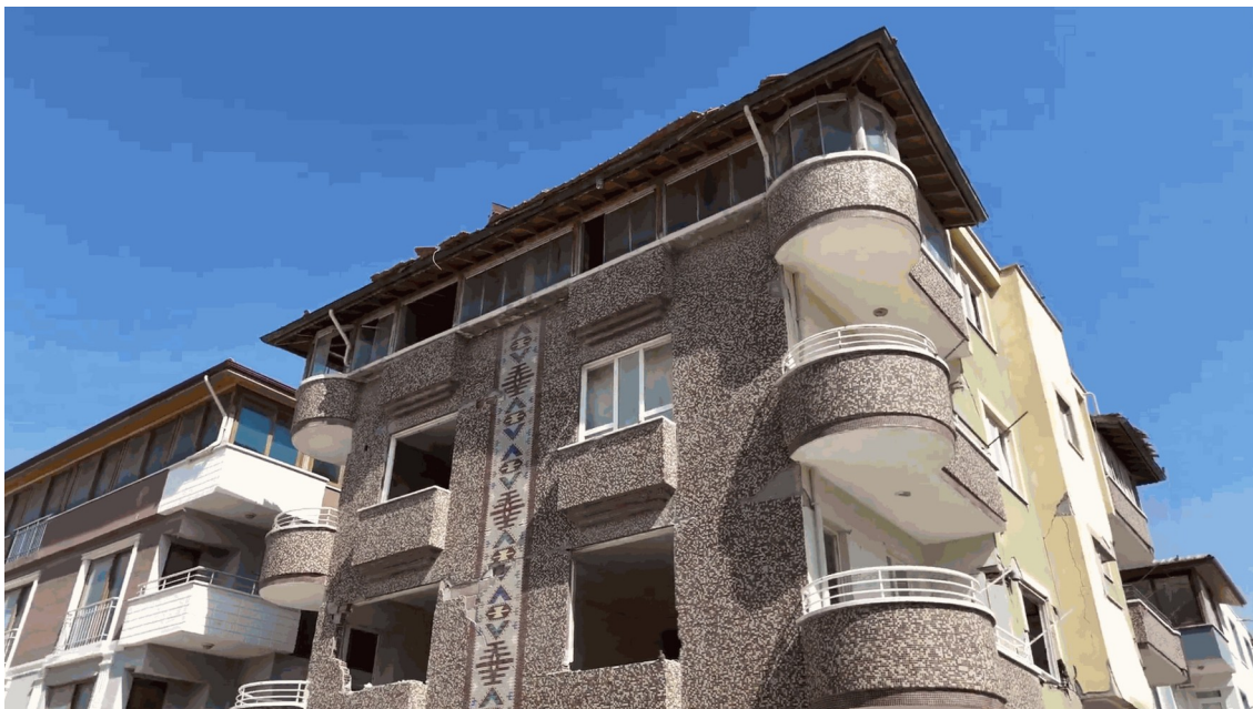
Figura 2. Vista oblíqua da fachada do edifício, destacando fissuras diagonais em torno das varandas e das ligações viga-pilar, utilizada para identificar danos estruturais relacionados com sismos.
