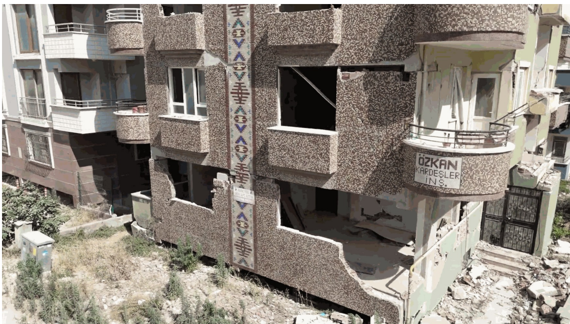
Figura 3. Vista do piso térreo que destaca pilares esmagados e paredes de enchimento colapsadas junto à entrada, utilizada para a identificação prática de danos estruturais relacionados com o sismo.
