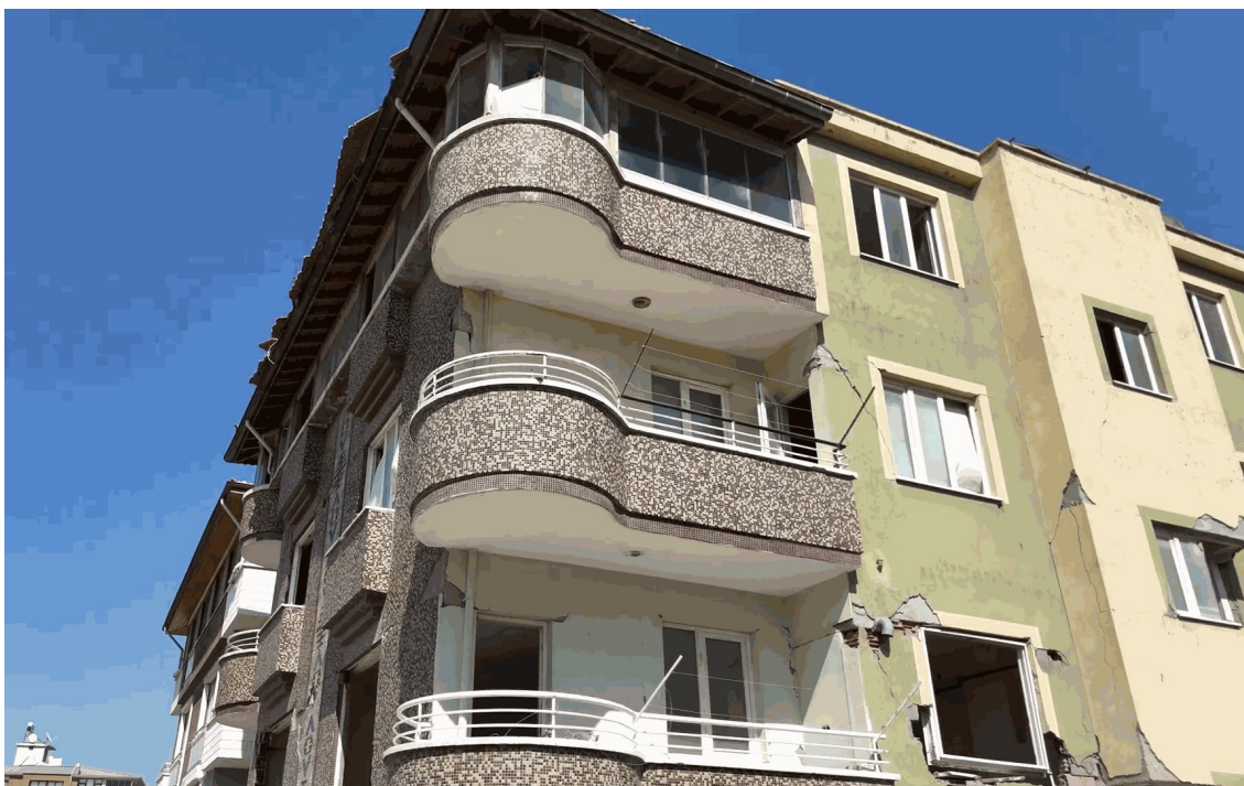
Figura 5. Vista da fachada superior que ilustra fissuração diagonal nas paredes de enchimento e deslocamentos em torno dos vãos das janelas.
