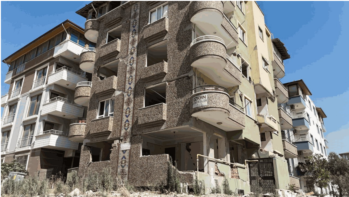
Figura 1. Vista frontal de um edifício residencial de betão armado danificado por um sismo em Hatay, mostrando o colapso parcial do piso térreo e fissuras na fachada, ilustrando danos típicos em edifícios após um sismo e os riscos de segurança associados.
