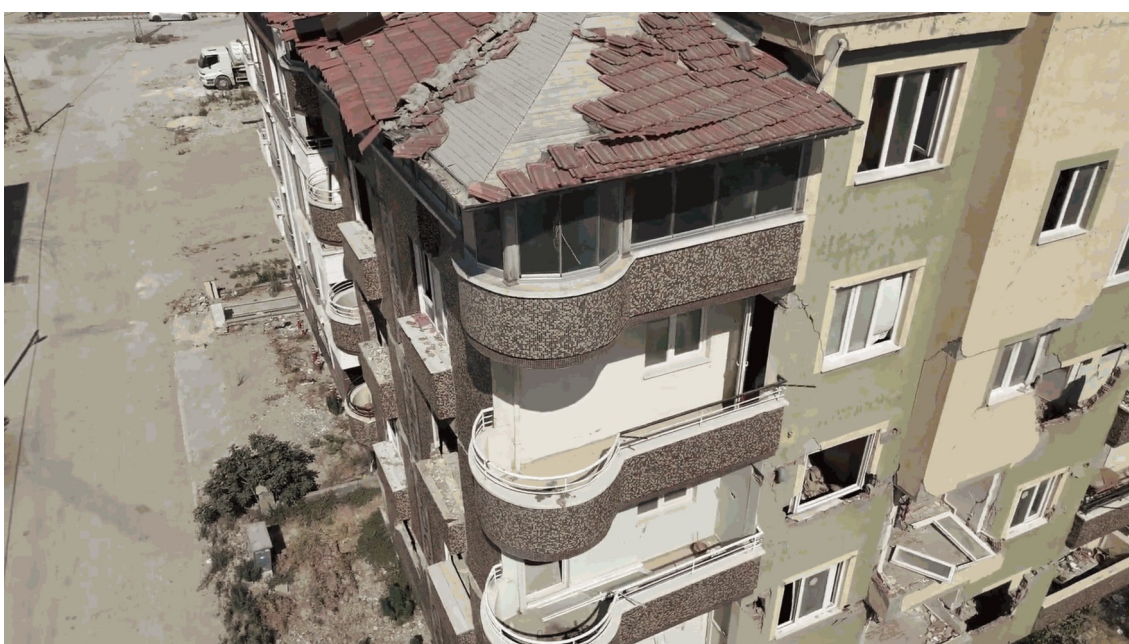
Figura 8. Vista oblíqua superior captada por drone que mostra a fragmentação do revestimento da cobertura e a falha parcial da parede de platibanda, indicando danos não estruturais e risco de queda de detritos.
