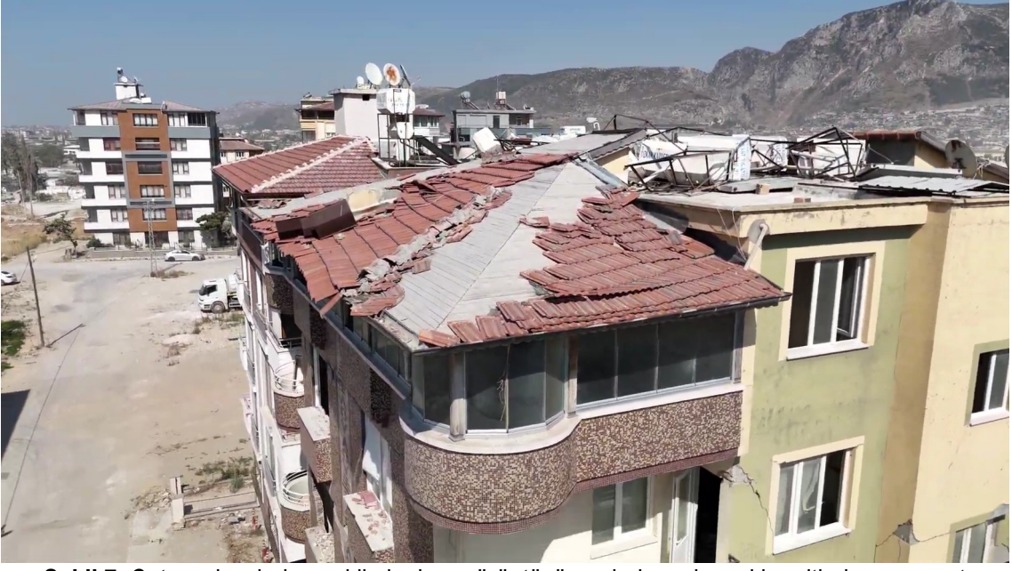
Şekil 7. Çatı seviyesinden çekilmiş dron görüntüsü, yerinden çıkmış kiremitleri ve parapet duvarındaki hasarı göstermekte olup, bu durum yapısal olmayan bir arızaya ve düşen enkaz tehlikesine işaret etmektedir.
