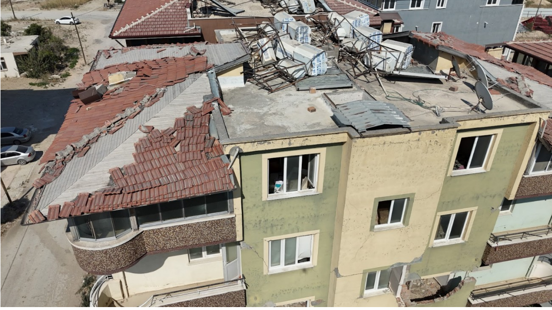
Şekil 9. Çatının yer değiştirme eğimini ve terasta biriken enkazı gösteren dikey dron görüntüsü; bu durum, olası düşme tehlikelerini ve yapısal olmayan hasarları ortaya koymaktadır.
