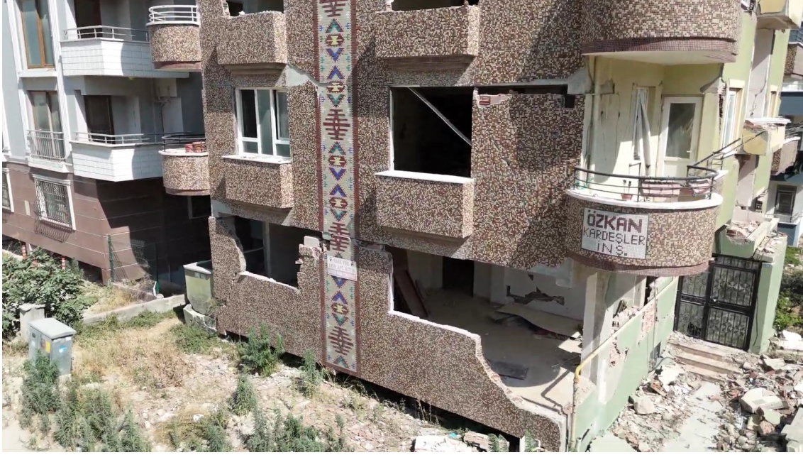
Şekil 3. Girişin yakınındaki ezilmiş sütunları ve çökmüş dolgu duvarlarını gösteren zemin kat görünümü; deprem kaynaklı yapısal hasarın yerinde tespit edilmesi amacıyla kullanılır.
