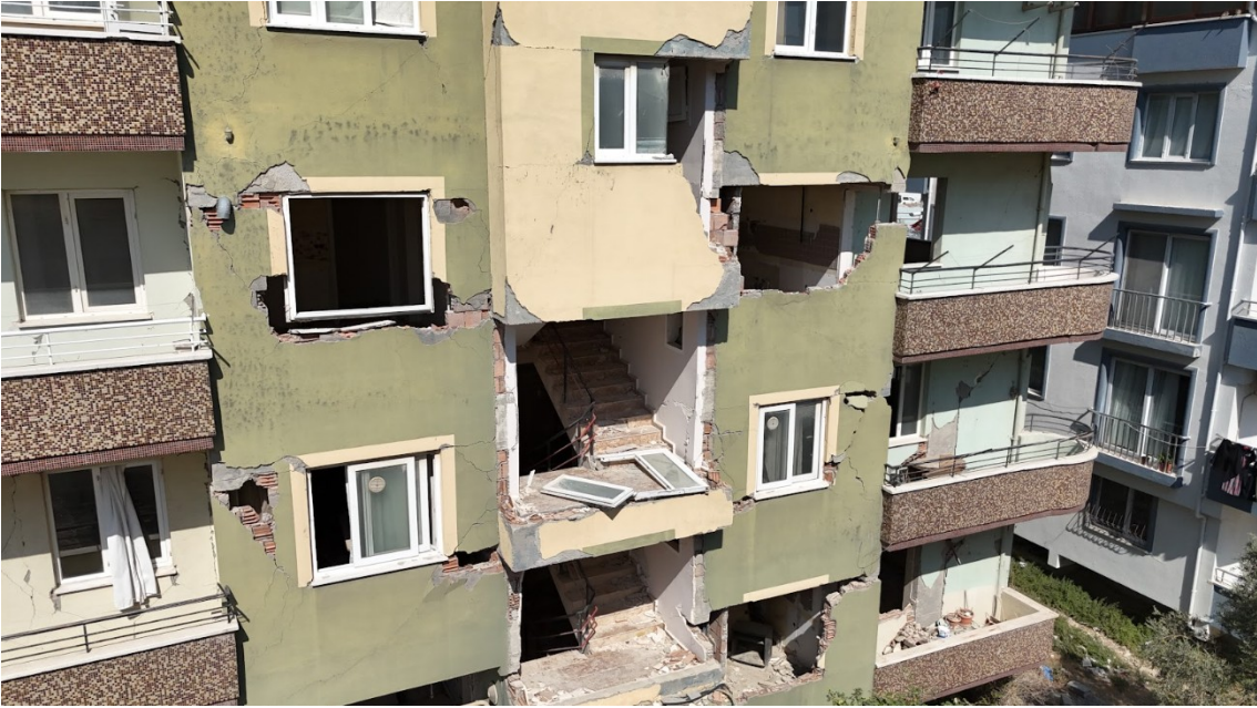
Şekil 10. Arka cephenin dron görüntüsü, merdiven boşluğunun açıkta kaldığını ve dolgu duvarının çöktüğünü gösterirken, betonarme iskelet büyük ölçüde sağlam kalmıştır; bu da yapının can güvenliği düzeyinde yapısal performans sergilediğini göstermektedir.
