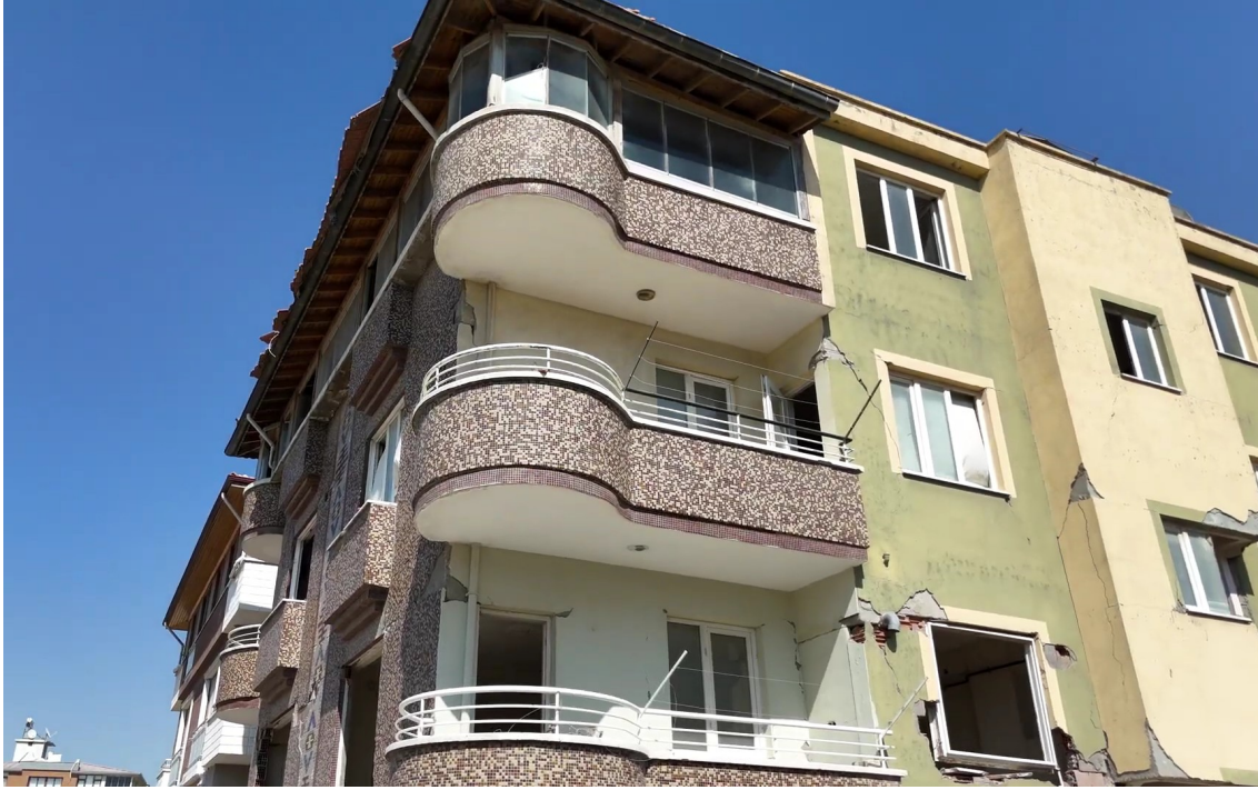
Şekil 5. Dolgu duvarlarındaki çapraz çatlakları ve pencere açıklıkları çevresindeki yer değiştirmeyi gösteren üst cephe görünümü.
