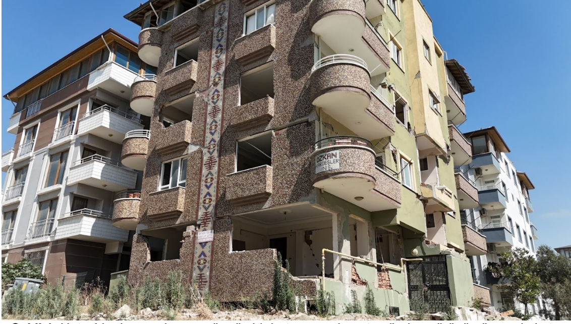
Şekil 1. Hatay'da deprem hasarı görmüş bir betonarme konutun önden görünümü; zemin katın kısmen çökmesi ve cephedeki çatlaklar, tipik deprem sonrası bina hasarlarını ve buna bağlı güvenlik risklerini göstermektedir.
