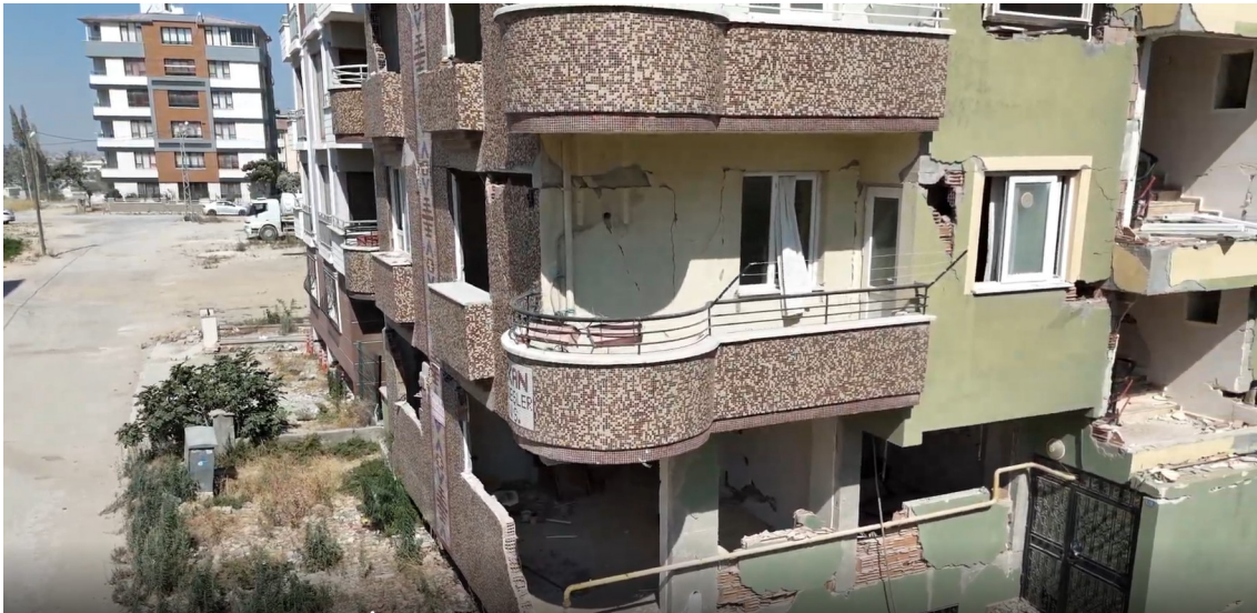
Şekil 4. Köşe kolonları ve balkonlarda oluşan eğilme hasarını gösteren yan görünüm.
