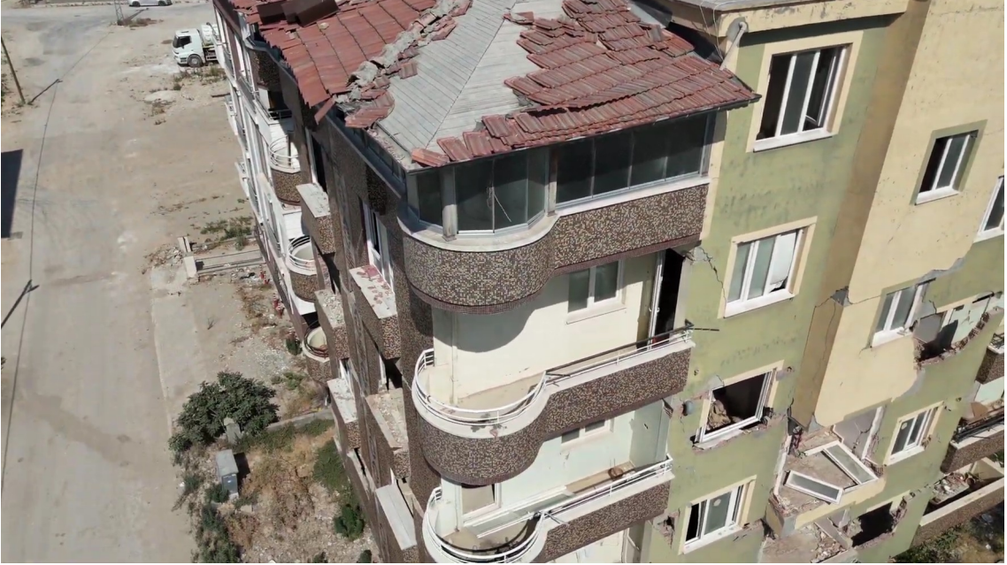
Şekil 8. Yukarıdan çekilmiş eğik dron görüntüsü, parçalanmış çatı kaplamasını ve parapet duvarının kısmi çökmesini göstermekte olup, bu durum yapısal olmayan hasar ve düşen moloz riskine işaret etmektedir.
