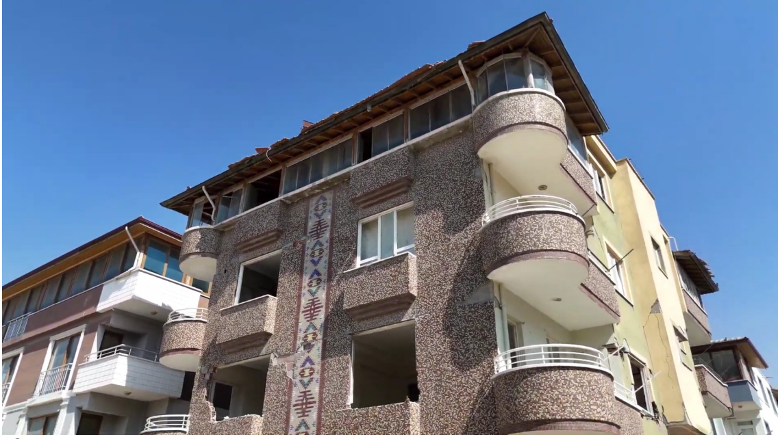
Şekil 2. Bina cephesinin eğik açıdan çekilmiş görüntüsü; balkonların çevresindeki ve giriş-kolon bağlantı yerlerindeki çapraz çatlakları göstermekte olup, deprem kaynaklı yapısal hasarı tespit etmek için kullanılmaktadır.
