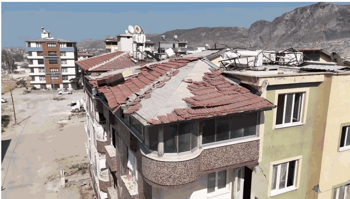
Obrázok 7. Záber z dronu na úrovni strechy zobrazujúci uvoľnené strešné krytiny a poškodený atikový múr, poukazujúci na poruchy nenosných konštrukcií a riziko pádu stavebných prvkov.
