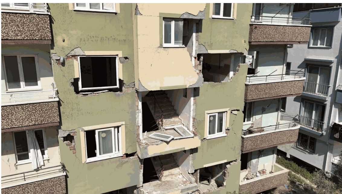
Obrázok 10. Záber zadnej fasády z dronu zobrazujúci odkryté schodisko a porušené výplňové murivo, pričom železobetónový nosný skelet zostáva vo veľkej miere neporušený, čo naznačuje zachovanie únosnosti konštrukcie na úrovni ochrany života.
