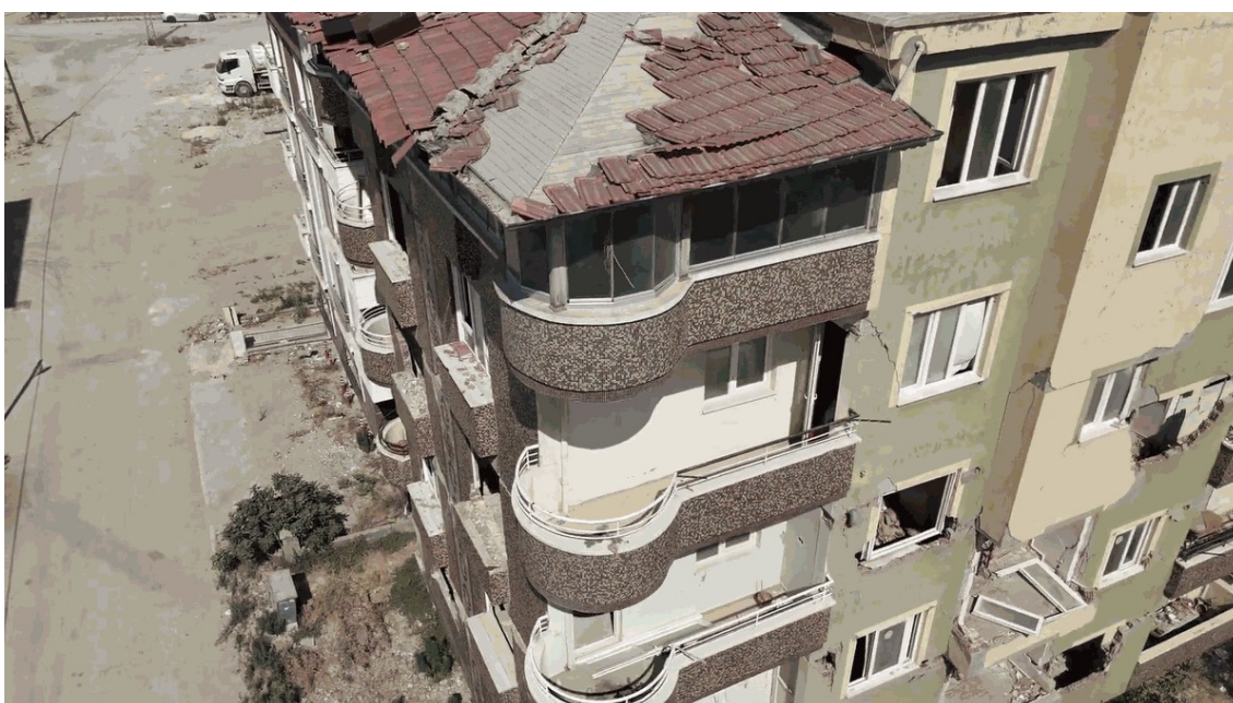
Obrázok 8. Horný šikmý záber z dronu zobrazujúci rozrušenú strešnú krytinu a čiastočne zrútený atikový múr, poukazujúci na poškodenie nenosných konštrukcií a riziko pádu stavebných prvkov.
