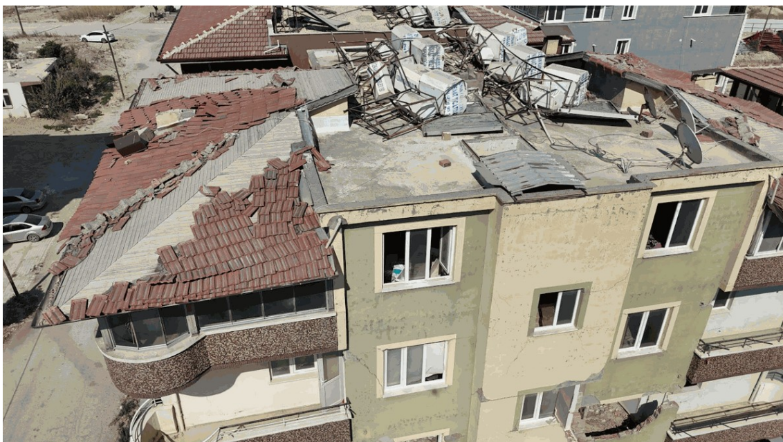
Obrázok 9. Vertikálny záber z dronu zobrazujúci postupný posun strešnej konštrukcie a nahromadené trosky na terase, poukazujúci na možné riziko pádu stavebných prvkov a poškodenie nenosných konštrukcií.
