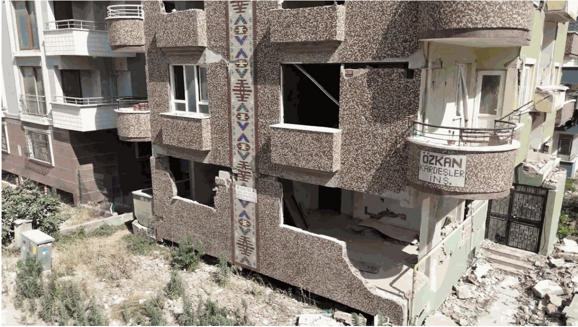
Obrázok 3. Pohľad na prízemie budovy zobrazujúci rozdrvené stĺpy a zrútené výplňové murivo v oblasti vstupu, využívaný na praktickú identifikáciu poškodenia nosnej konštrukcie spôsobeného zemetrasením.
