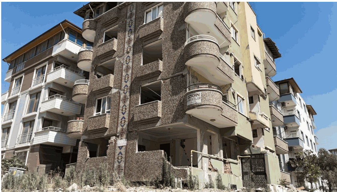
Obrázok 1. Pohľad spredu na železobetónovú obytnú budovu poškodenú zemetrasením v provincii Hatay so zrútenou časťou prízemia a popraskanou fasádou, ilustrujúci typické poškodenia budov po zemetrasení a s nimi súvisiace bezpečnostné riziká.
