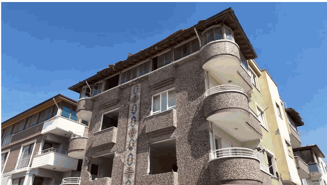
Obrázok 2. Šikmý pohľad na fasádu budovy zvyrazňujúci diagonálne trhliny v okolí balkónov a spojov nosníkov so stĺpmi, využívaný na identifikáciu poškodenia konštrukcie spôsobeného zemetrasením.
