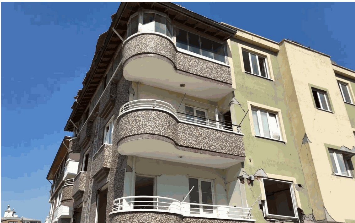
Obrázok 5. Pohľad na hornú časť fasády zobrazujúci diagonálne trhliny vo výplňovom murive a posuny v okolí okenných otvorov.
