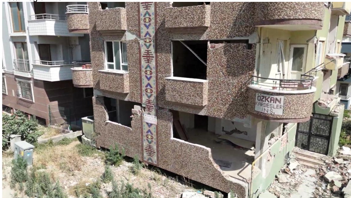
Figura 3. Vista dal piano terra che evidenzia le colonne schiacciate e i muri di tamponamento crollati vicino all'ingresso, utilizzata per l'identificazione diretta dei danni strutturali causati dal terremoto.
