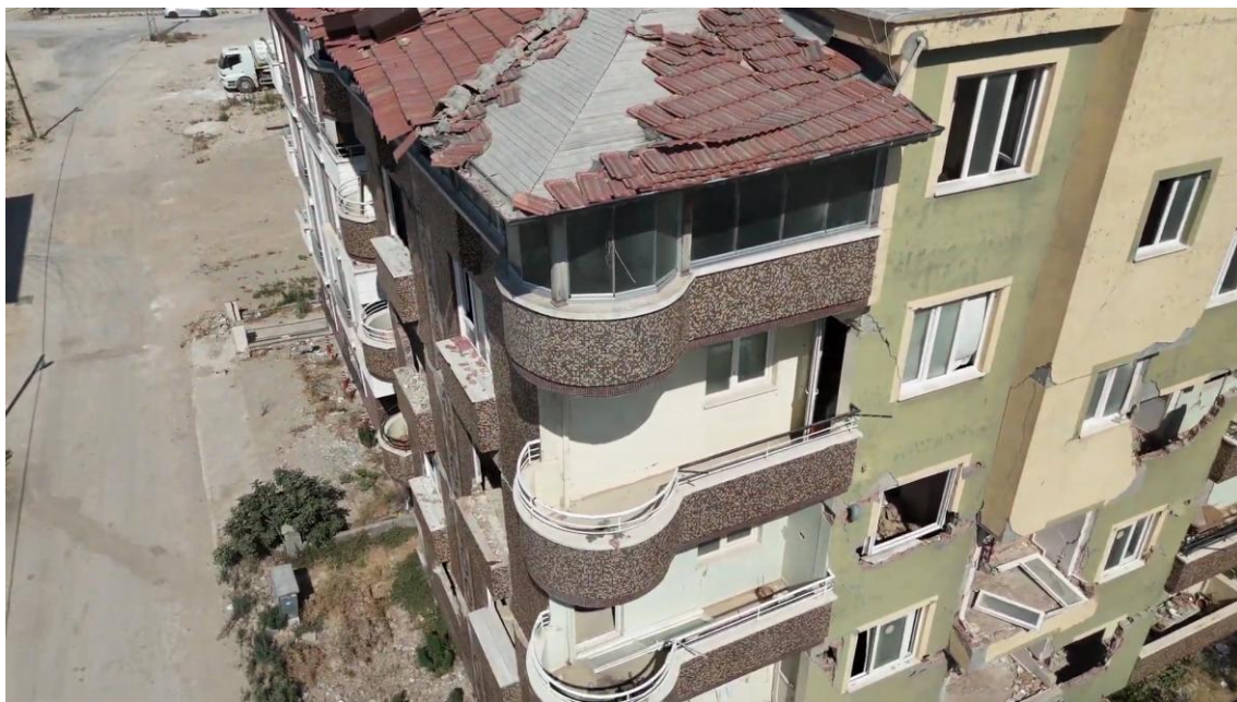
Figura 8. Vista aerea obliqua ripresa da un drone che mostra la copertura del tetto frammentata e il cedimento parziale del parapetto, indicando danni non strutturali e rischio di caduta di detriti.
