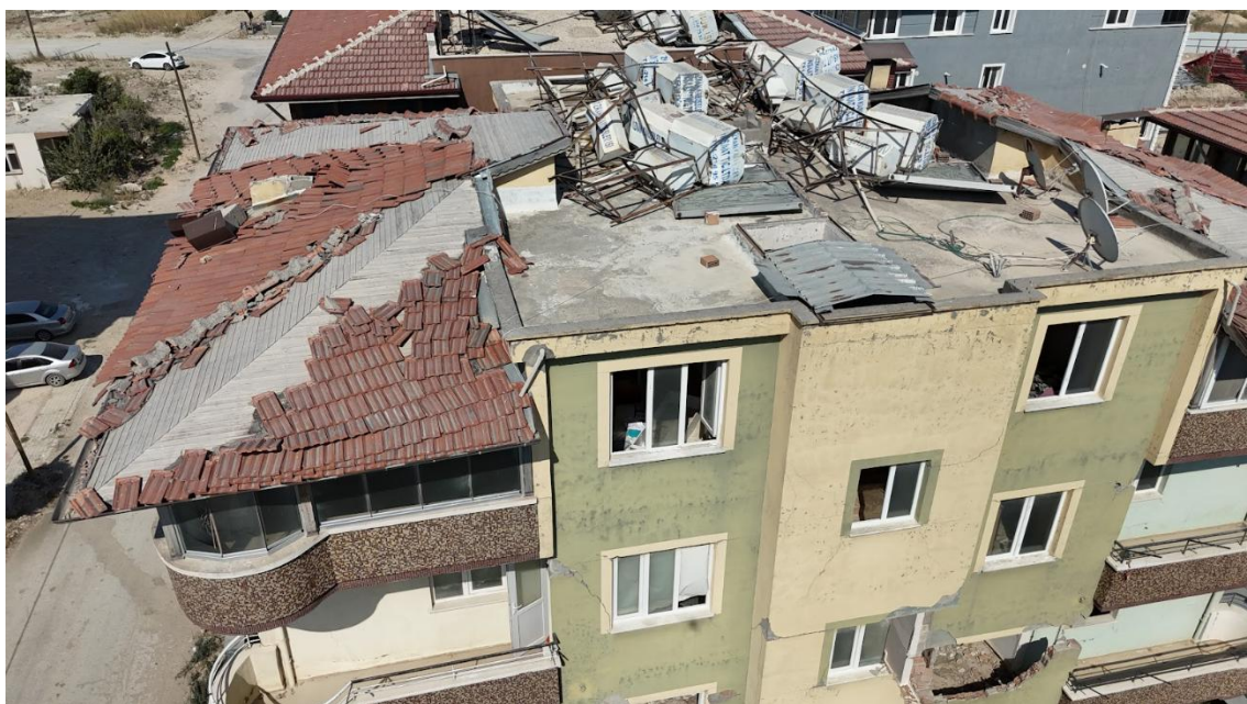
Figura 9. Immagine ripresa da un drone in verticale che mostra il gradiente di spostamento del tetto e l'accumulo di detriti sulla terrazza, indicando potenziali rischi di caduta e danni non strutturali.
