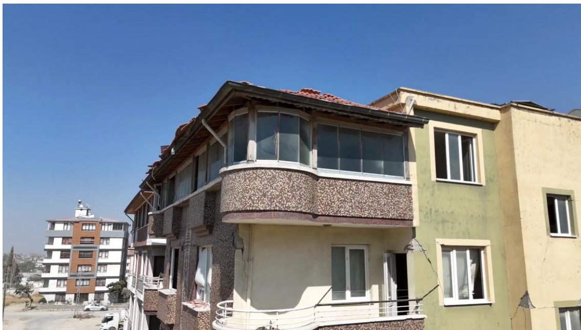
Figura 6. Vista obliqua ripresa da un drone che mostra la rotazione della facciata e il disallineamento della linea del tetto rispetto agli edifici circostanti.
