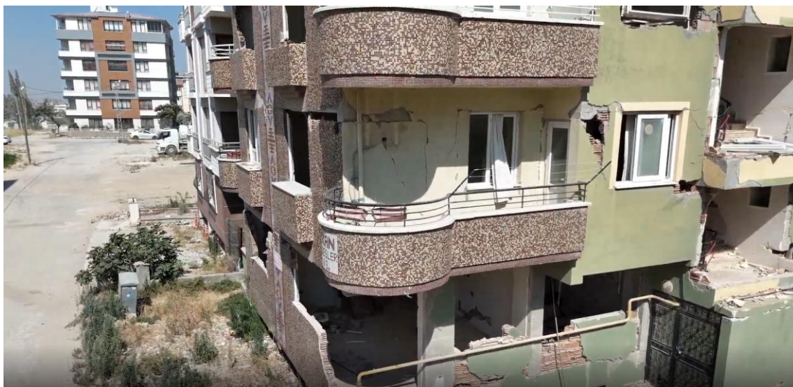
Figura 4. Vista laterale che mostra gli effetti del danno torsionale su colonne angolari e balconi.
