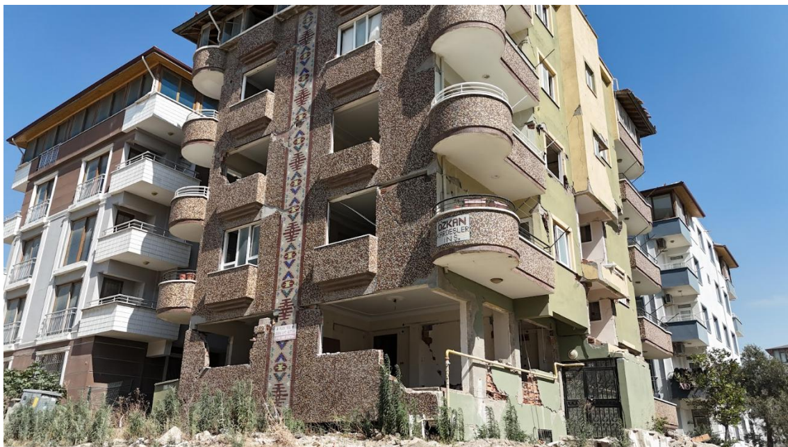
Figura 1. Vista frontale di un edificio residenziale in cemento armato danneggiato dal terremoto a Hatay, che mostra il parziale crollo del piano terra e le crepe nella facciata, a dimostrazione dei tipici danni agli edifici successivi a un terremoto e dei relativi rischi per la sicurezza.
