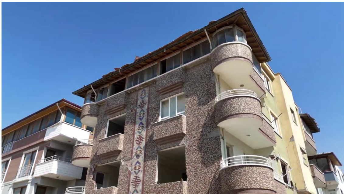
Figura 2. Vista obliqua della facciata dell'edificio che evidenzia le crepe diagonali intorno ai balconi e ai collegamenti tra travi e pilastri, utilizzate per identificare i danni strutturali causati dal terremoto.
