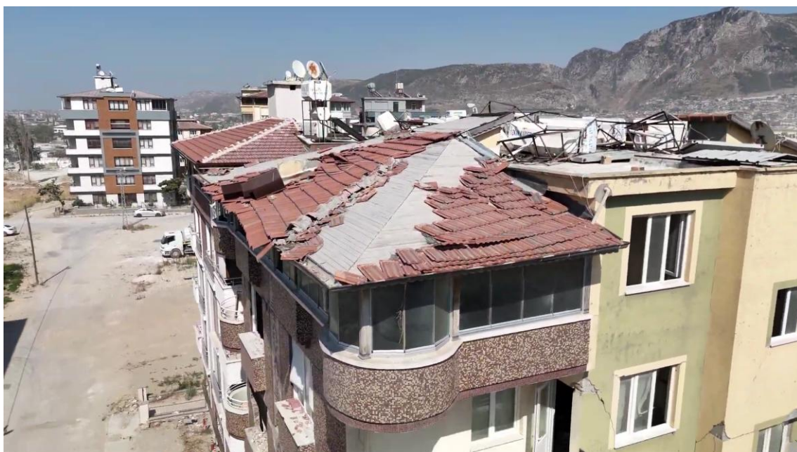
Figura 7. Immagini riprese dal drone a livello del tetto che mostrano tegole staccate e danni al parapetto, indicando un cedimento non strutturale e un rischio di caduta di detriti.
