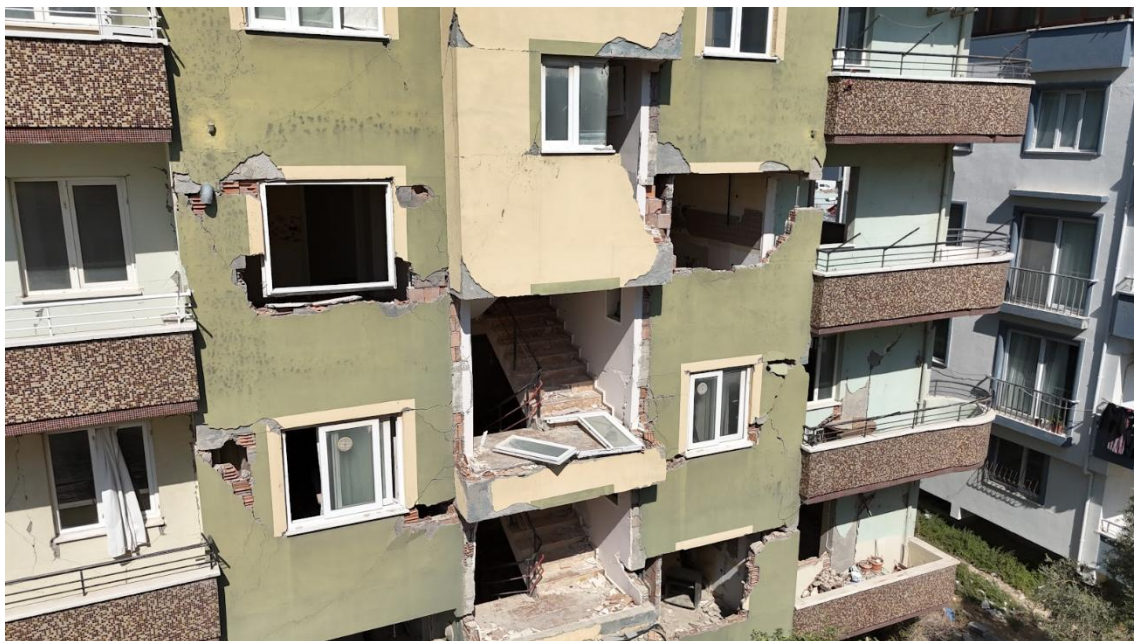
Figura 10. Le immagini riprese da un drone sulla facciata posteriore mostrano l'esposizione del vano scale e il cedimento del muro di tamponamento, mentre la struttura in cemento armato rimane in gran parte intatta, indicando un livello di sicurezza strutturale adeguato.
