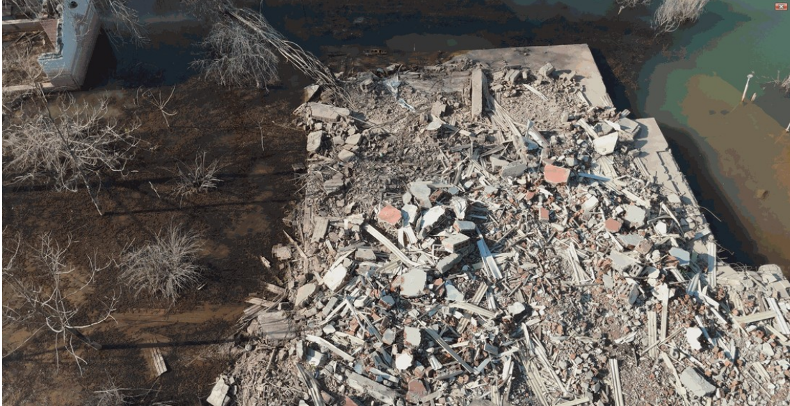
Şekil 15. Göl kıyısı yakınlarında su altında kalan çökmüş betonarme yapının ayrıntılı görüntüsü; bu görüntüde şiddetli yanal zemin hareketi ve temel çökmesi görülmektedir.
