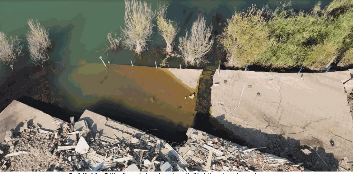
Şekil 16. Göl yüzeyinin altında görülebilen batık park yapısı.
