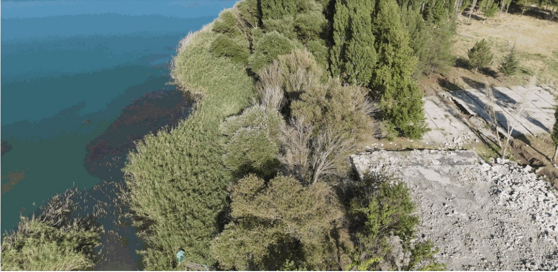
Şekil 12. Su hattı yakınındaki çatlamış beton levhaların dron ile çekilmiş yakın plan görüntüsü; bu görüntü, yanal toprak kaymasıyla ilişkili yerel çöküntüleri göstermektedir.
