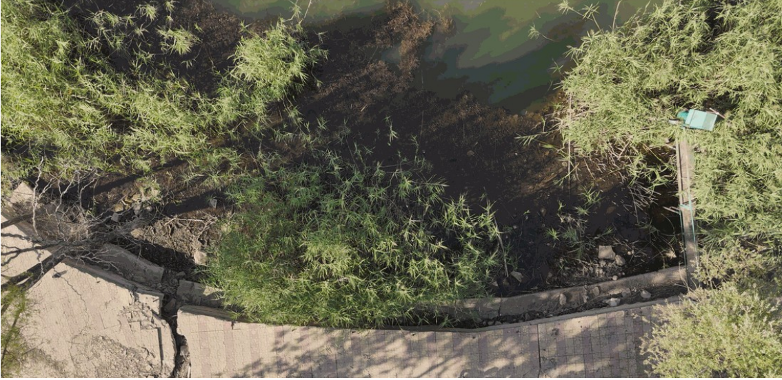
Şekil 2. Deprem sonrasında göl kenarındaki kaldırımda görülen ilk çatlaklar ve çöküntüleri gösteren yukarıdan aşağıya dron görüntüsü.
