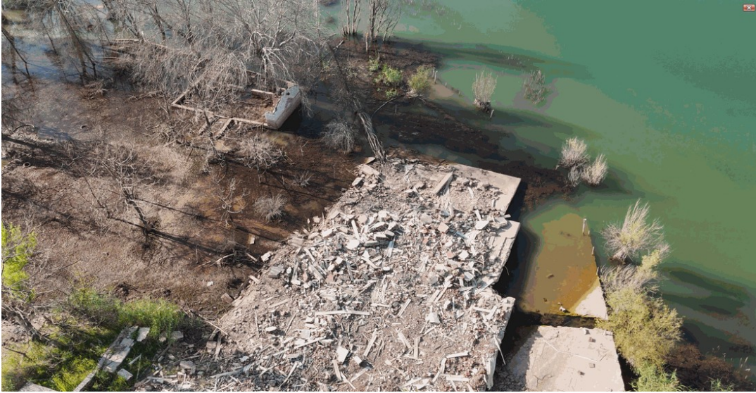
Şekil 13. Yanal yayılma ve toprak kayması nedeniyle göl kenarındaki yıkılmış yapı kısmen su altında kalmıştır.
