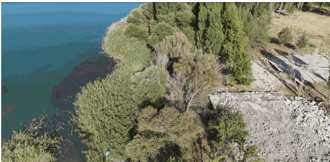
Obrázok 12. Detailný záber z dronu zobrazujúci popraskané betónové dosky v blízkosti brehovej línie, poukazujúce na lokálne porušenie spôsobené bočným posunom pôdy.
