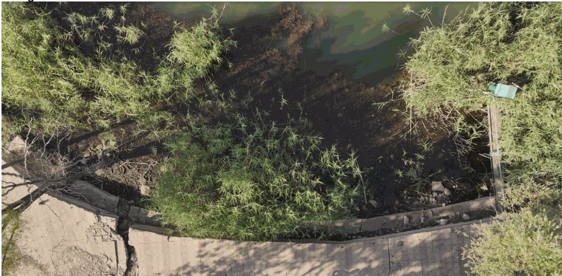
Obrázok 2. Pohľad zhora z dronu zobrazujúci počiatočné povrchové trhliny a nerovnomerné sadanie terénu pozdĺž spevnenej plochy pri brehu jazera po zemetrasení.
