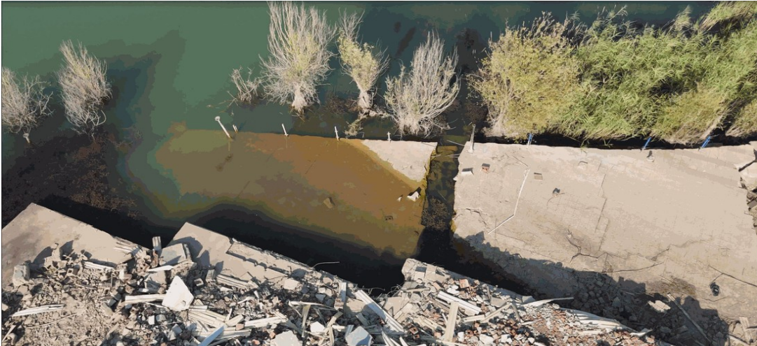
Obrázok 16. Zaplavená parková konštrukcia viditeľná pod hladinou jazera.
