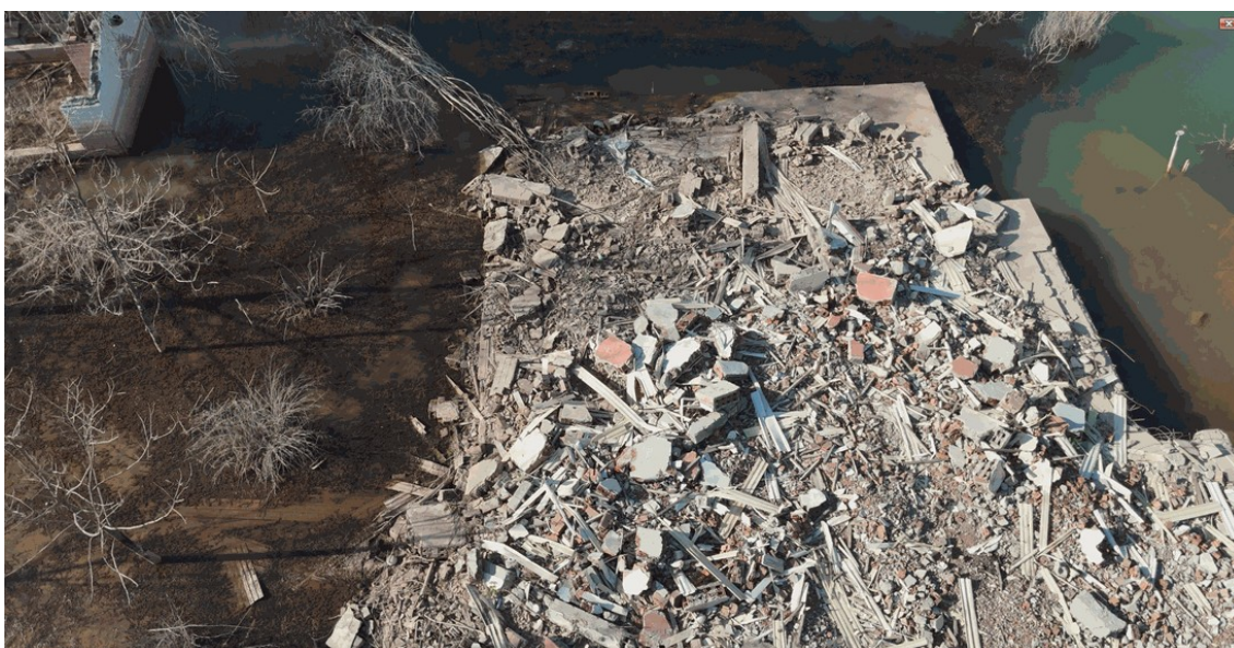
Obrázok 15. Detailný záber z dronu zobrazujúci zrútenú železobetónovú konštrukciu čiastočne zaplavenú pri brehu jazera, s viditeľnými prejavmi výrazného bočného pohybu pôdy a porušenia základovej konštrukcie.
