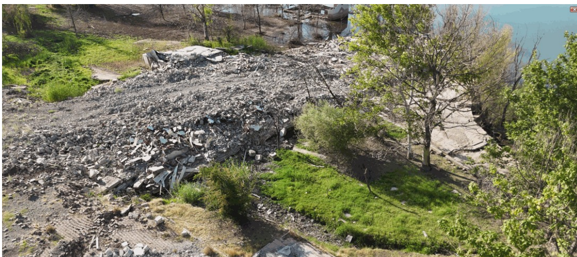
Obrázok 14. Nahromadené trosky zrútených konštrukcií a deformovaný povrch svahu pri brehu jazera, poukazujúce na výrazný pohyb pôdy smerom k vodnej ploche po zemetrasení.
