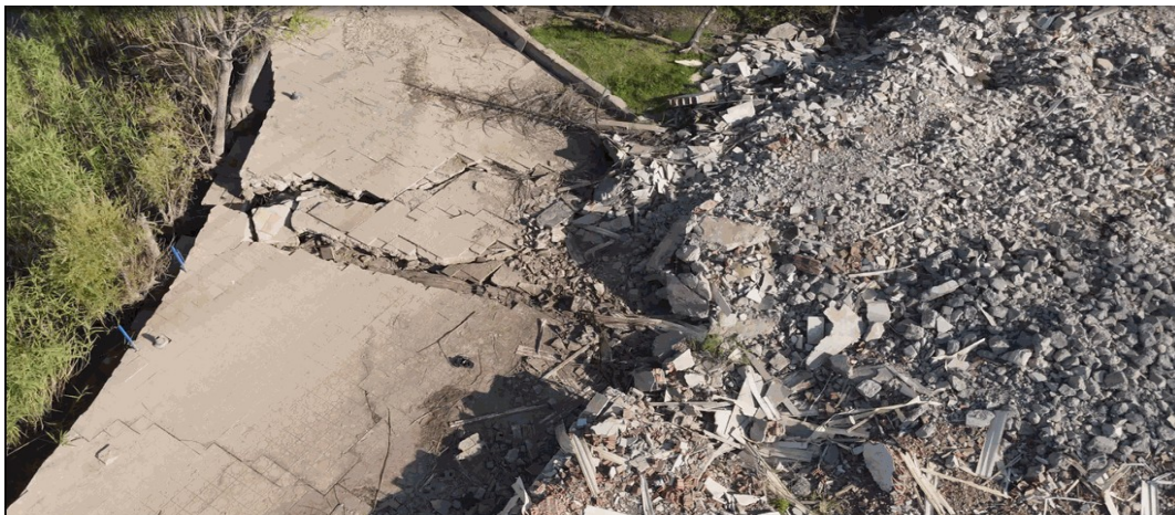
Obrázok 17. Posunutý oporný múr a vychýlené rady stromov naznačujúce bočné rozširovanie pôdy a nerovnomerný pohyb terénu smerom k brehu jazera.
