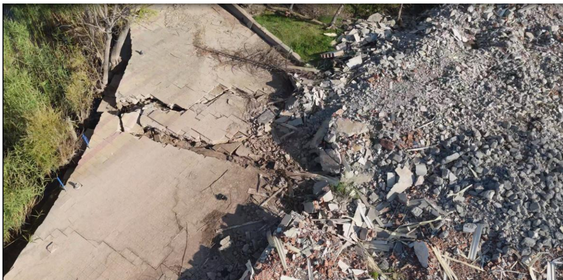
Figura 17. Il muro di contenimento spostato e le file di alberi disallineate indicano un'espansione laterale del terreno e un movimento differenziale del suolo verso la riva del lago.
