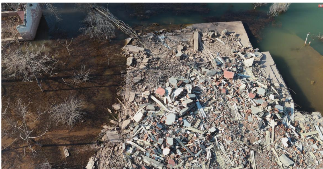
Figura 15. Vista dettagliata della struttura in cemento armato crollata e sommersa vicino alla riva del lago, che mostra gravi movimenti laterali del terreno e cedimenti delle fondamenta.
