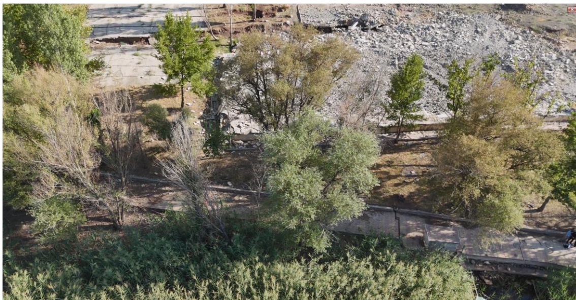
Figura 4. Immagine ripresa da un drone che mostra una passerella pedonale crepata accanto a un terreno saturo d'acqua in seguito a un terremoto.
