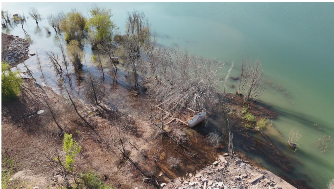
Figura 9. Riprese aeree effettuate con un drone che mostrano il crollo della pavimentazione in riva al lago, con evidente rotazione della superficie, in seguito a un terremoto.
