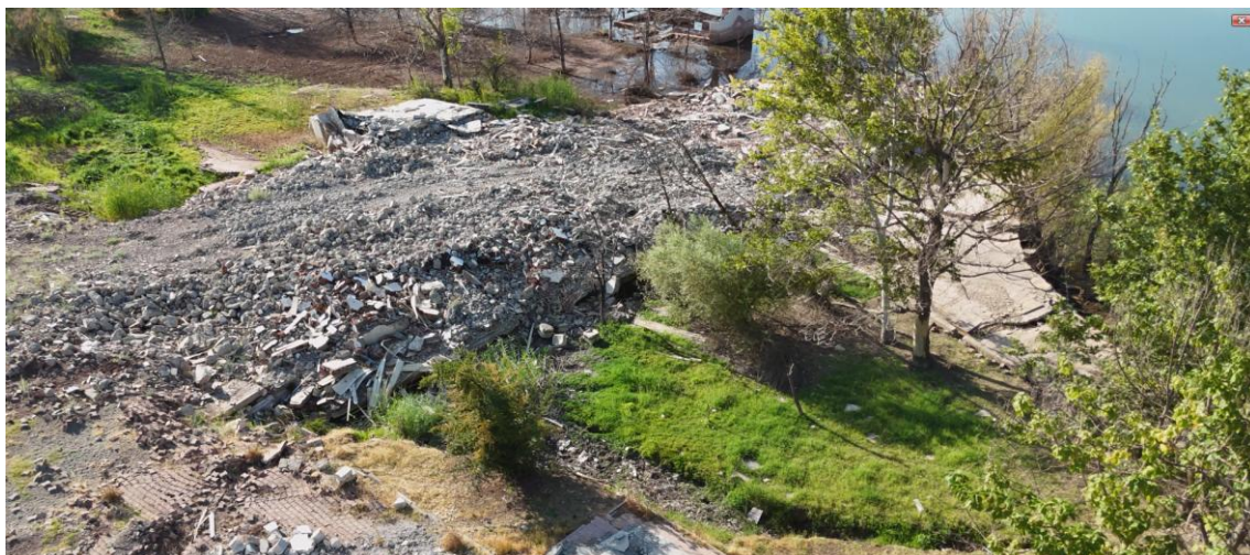
Figura 14. L'accumulo di detriti dovuti al crollo e lo spostamento della superficie lungo il pendio lacustre indicano un grave movimento del terreno verso il lago.
