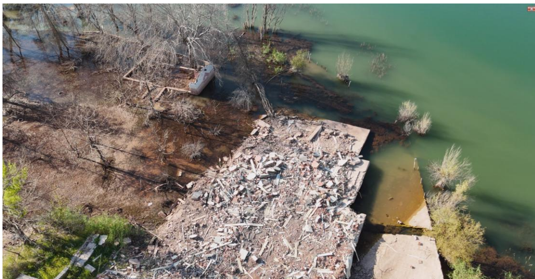
Figura 13. Struttura lacustre crollata, parzialmente sommersa dall'acqua a causa dell'espansione laterale e dello spostamento del terreno.
