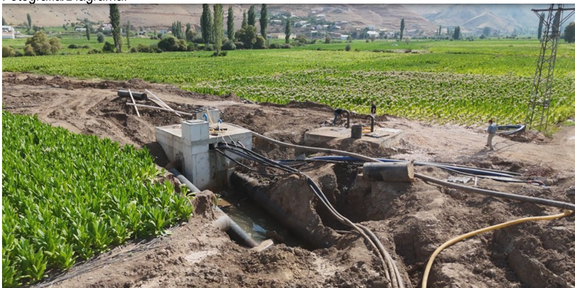
Figura 2. Vista geral de uma estrutura de transporte de água danificada, ilustrando deformações visíveis, componentes expostos e
