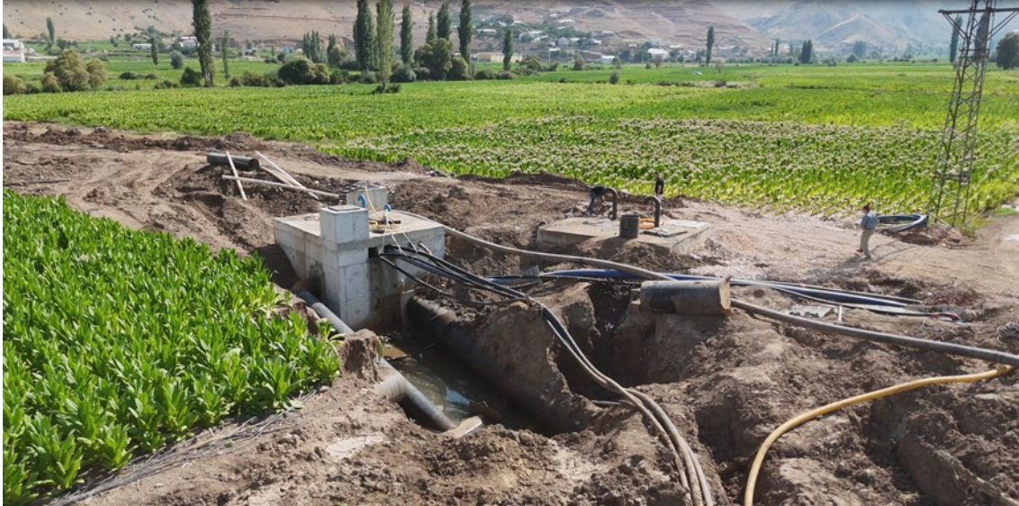
Şekil 2. Deprem sonrası gözle muayene sırasında incelenebilecek, görülür deformasyonları, açıkta kalan bileşenleri ve çevresindeki zemin koşullarını gösteren hasarlı bir su iletim yapısına genel bakış.
