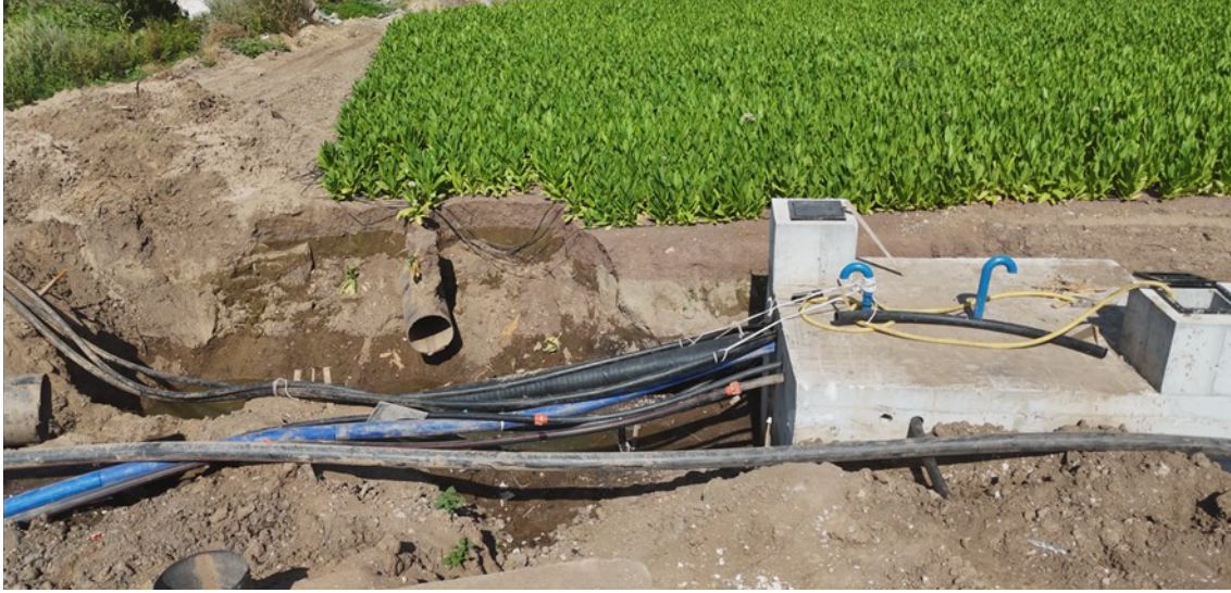
Şekil 5. Su iletim yapısı içindeki yerinden çıkmış bağlantı noktaları da dahil olmak üzere gözle görülür hasarı gösteren yakın çekim dron görüntüsü; bu görüntü, yerinde inceleme sırasında ayrıntılı görsel denetim ve belgeleme amacıyla kullanılır.
