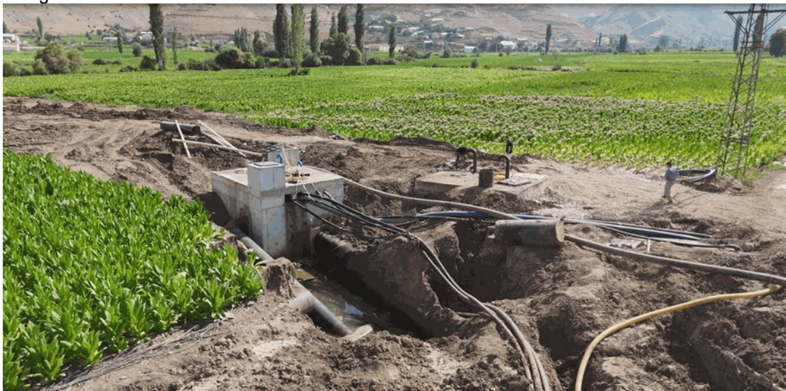
Obrázok 2. Celkový pohľad na poškodenú vodnú stavbu zobrazujúci viditeľné deformácie, obnažené konštrukčné prvky a stav okolitého terénu, ktoré možno posudzovať počas vizuálnej kontroly po zemetrasení.
