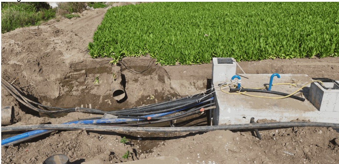
Obrázok 5. Detailný záber z dronu zobrazujúci viditeľné poškodenie vodnej stavby vrátane posunutých spojov konštrukcie. Obrázok je určený na podrobnú vizuálnu kontrolu a dokumentovanie zistených poškodení počas praktickej inšpekcie.
