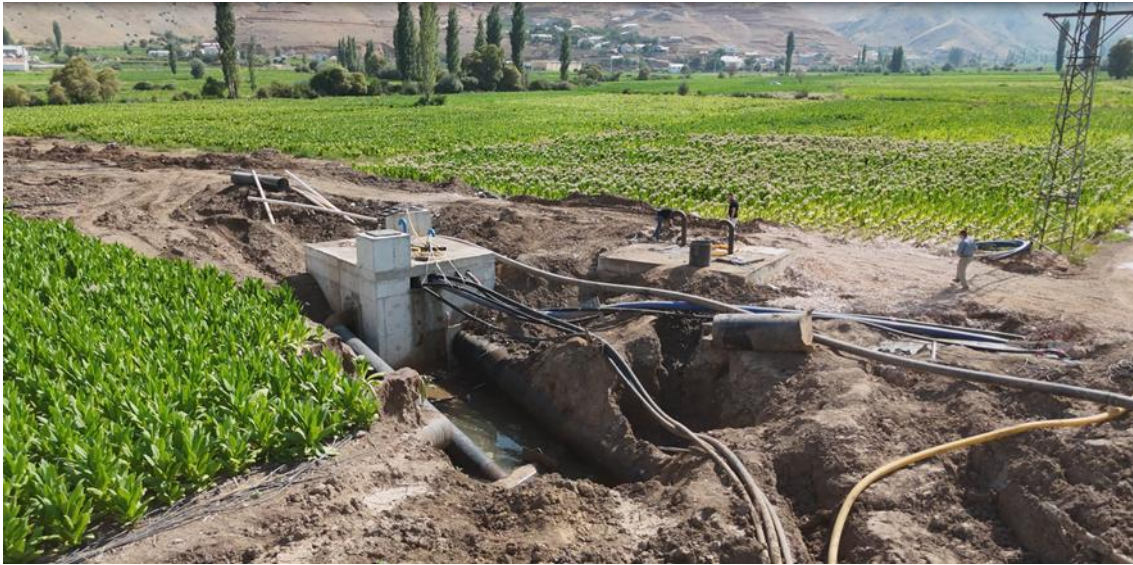
Figura 2. Panoramica di una struttura di trasmissione idrica danneggiata, che illustra la deformazione visibile, i componenti esposti e le condizioni del terreno circostante che possono essere esaminate durante un'ispezione visiva successiva al terremoto.
