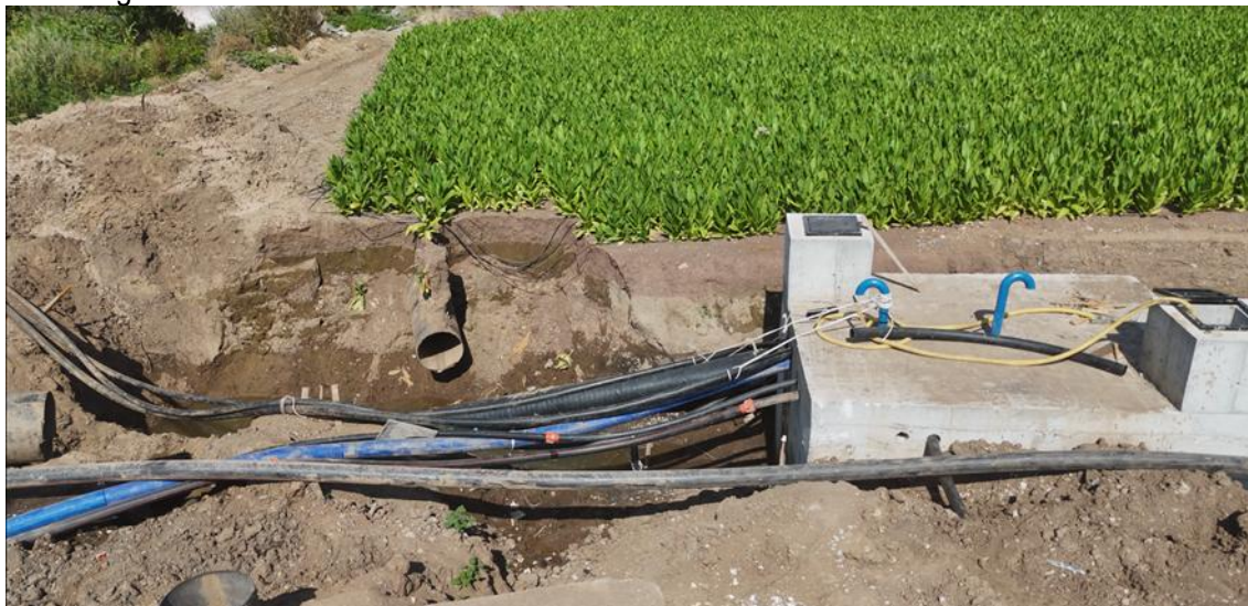
Figura 5. Immagine ravvicinata ripresa da un drone che mostra danni visibili all'interno di una struttura di trasmissione idrica, inclusi allacciamenti dislocati, utilizzata per un'ispezione visiva dettagliata e per la documentazione durante una valutazione sul campo.
