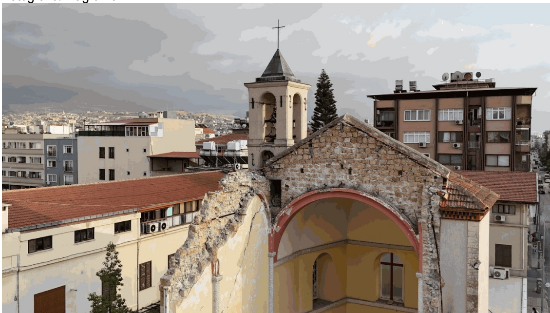
Figura 1. Vista geral dos danos causados por um sismo que afetam uma estrutura histórica, destacando as áreas que não são seguras para inspeção direta.
