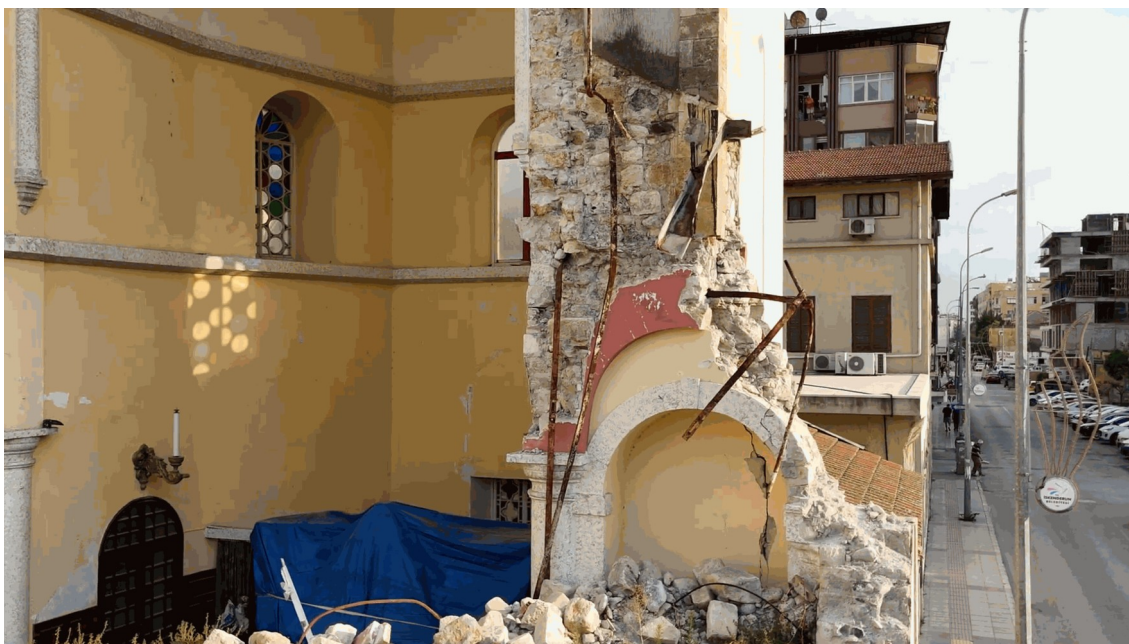
Figura 7. Vista que mostra danos visíveis relacionados com sismos numa estrutura histórica, com elementos deslocados e áreas superficiais instáveis.
