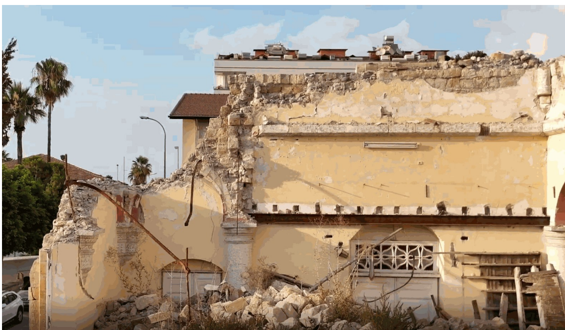
Figura 6. Vista de pormenor que mostra danos visíveis relacionados com sismos numa estrutura histórica, destacando áreas de separação e fissuração superficial.
