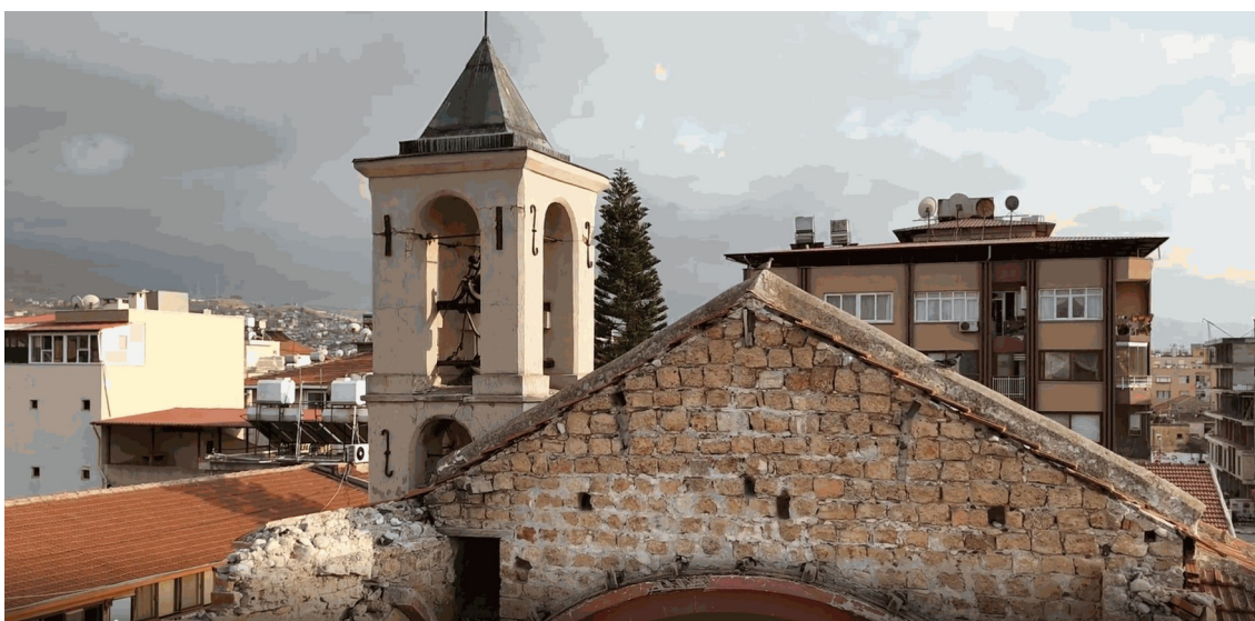
Figura 9. Vista intermédia obtida por drone, utilizada para documentar danos visíveis causados por um sismo nas partes superiores de uma estrutura histórica durante a inspeção.
