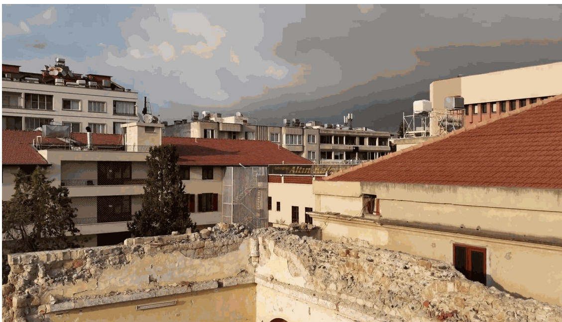
Figura 3. Vista de contexto que mostra a relação entre uma estrutura histórica danificada e os edifícios circundantes após um sismo.
