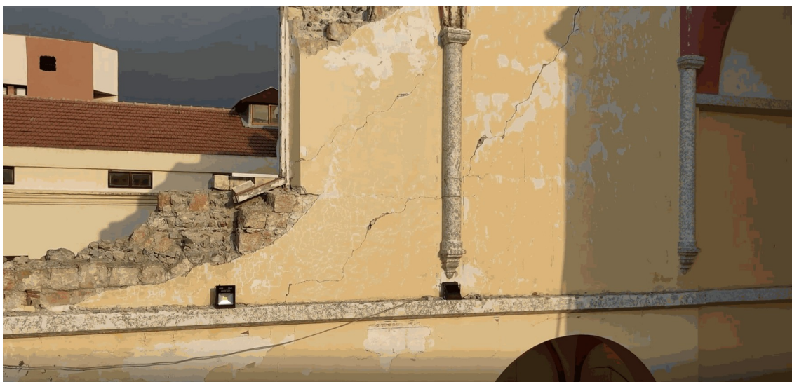
Figura 5. Fissuração visível relacionada com sismos nas paredes de uma estrutura histórica, ilustrando os padrões de danos identificados durante a inspeção visual.
