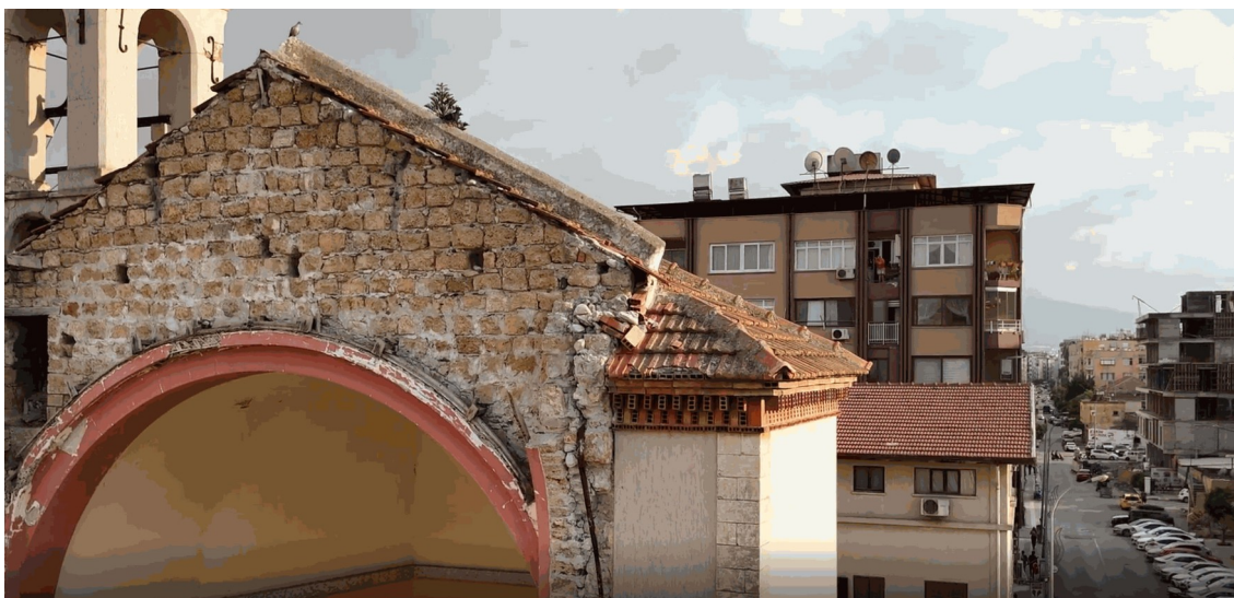
Figura 12. Vista obtida por drone durante a passagem final de inspeção, que mostra instabilidade relacionada com um sismo nas partes superiores de uma estrutura histórica.
