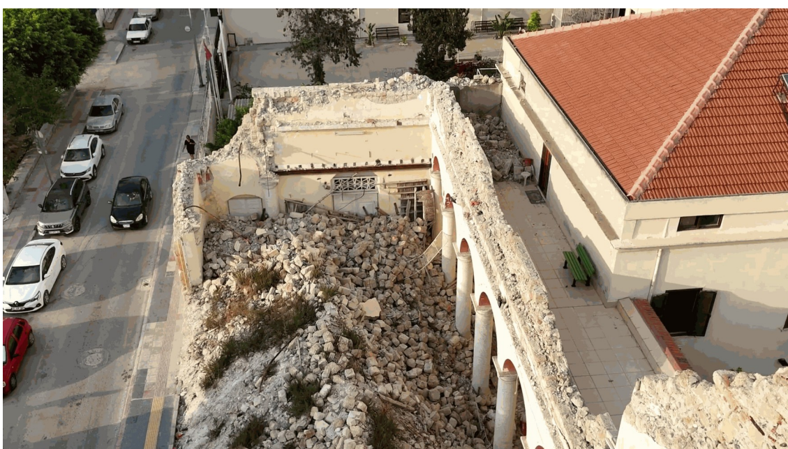
Figura 11. Vista vertical obtida por drone que destaca a distribuição de detritos relacionada com um sismo ao longo de uma estrutura histórica durante a inspeção visual.
