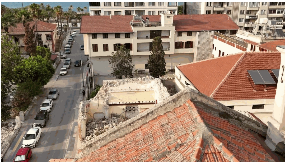
Figura 8. Vista geral obtida por drone que mostra danos causados por um sismo numa estrutura histórica e o contexto circundante durante a inspeção visual.
