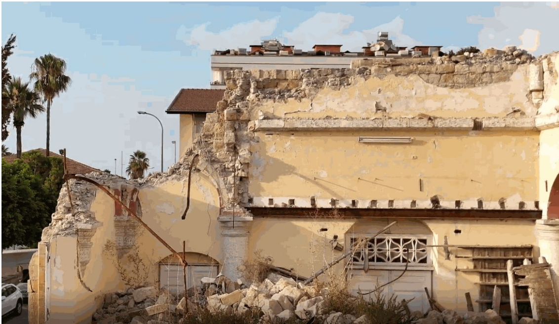
Şekil 6. Tarihi bir yapıda deprem kaynaklı hasarın gözle görülür olduğu yakın çekim görüntüsü; ayrılma ve yüzey çatlaklarının olduğu bölgeler açıkça görülmektedir.
