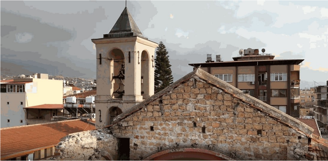
Şekil 9. Denetim sırasında tarihi bir yapının üst kısımlarındaki gözle görülür deprem hasarlarını belgelemek için kullanılan orta irtifalı dron görüntüsü.
