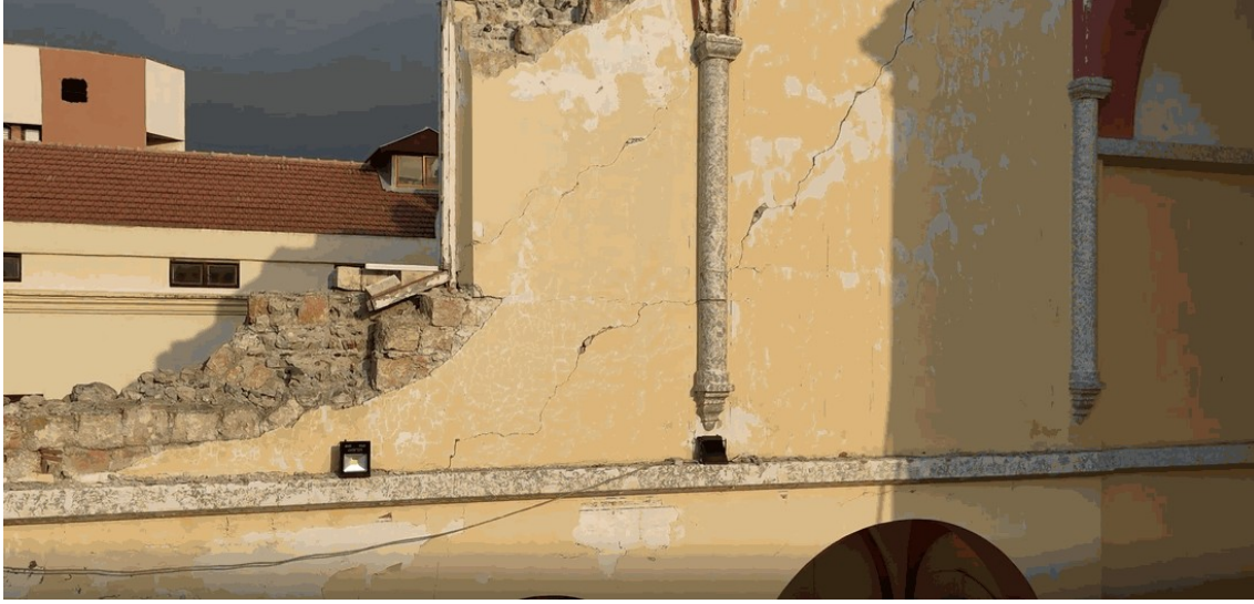
Şekil 5. Tarihi bir yapının duvarlarında gözle görülür deprem kaynaklı çatlaklar; bu çatlaklar, gözle yapılan inceleme sırasında tespit edilen hasar örüntülerini göstermektedir.
