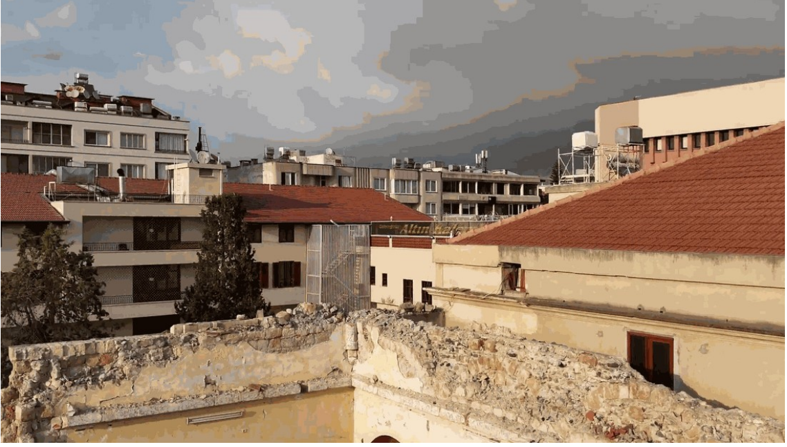
Şekil 3. Deprem sonrası hasar görmüş tarihi bir yapı ile çevresindeki binalar arasındaki ilişkiyi gösteren bağlam görünümü.
