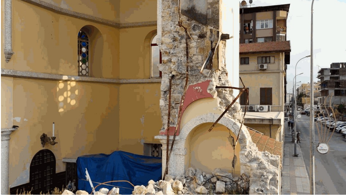
Şekil 7. Tarihi bir yapıda, yerinden çıkmış yapı elemanları ve dengesiz yüzey alanları ile birlikte deprem kaynaklı hasarın görüldüğü bir görünüm.
