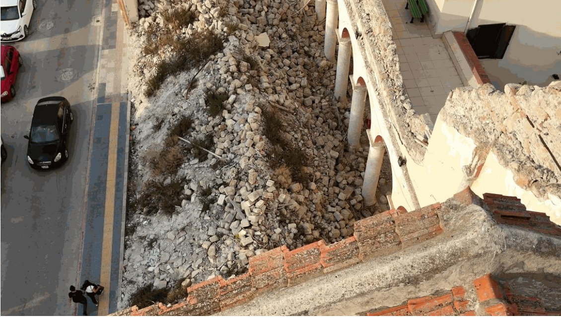
Şekil 10. Görsel inceleme sırasında tarihi bir yapının içindeki deprem kaynaklı çöküntü ve enkaz birikimini gösteren yukarıdan aşağıya dron görüntüsü.
