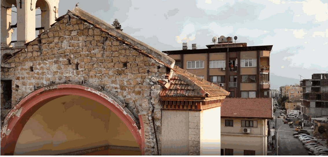
Şekil 12. Son denetim turu sırasında dron ile çekilen görüntü, tarihi bir yapının üst kısımlarında deprem kaynaklı dengesizliği göstermektedir.
