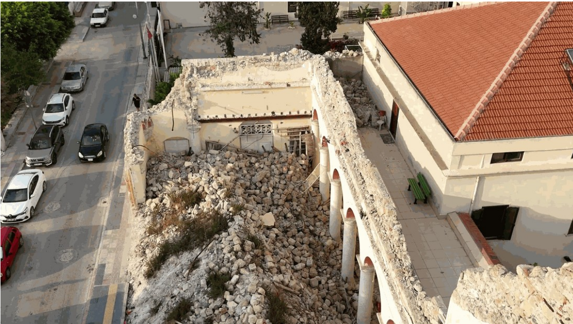
Şekil 11. Görsel inceleme sırasında tarihi bir yapı boyunca deprem kaynaklı enkaz dağılımını gösteren dikey dron görüntüsü.
