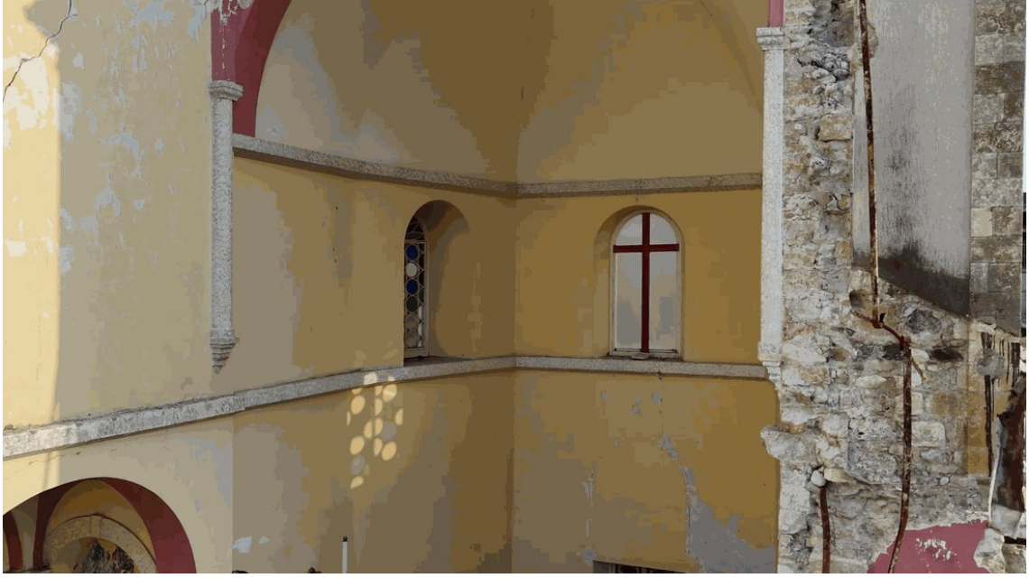
Şekil 4. Tarihi bir yapının yüzeylerinde ve dekoratif kısımlarında deprem kaynaklı hasarın görüldüğü iç mekan görüntüsü.
