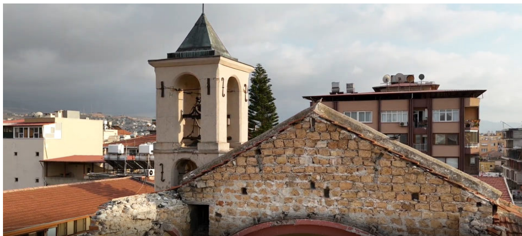
Obrázok 9. Pohľad z dronu zo strednej výšky použitý na zdokumentovanie viditeľných poškodení spôsobených zemetrasením na horných častiach historickej stavby počas vizuálnej kontroly.
