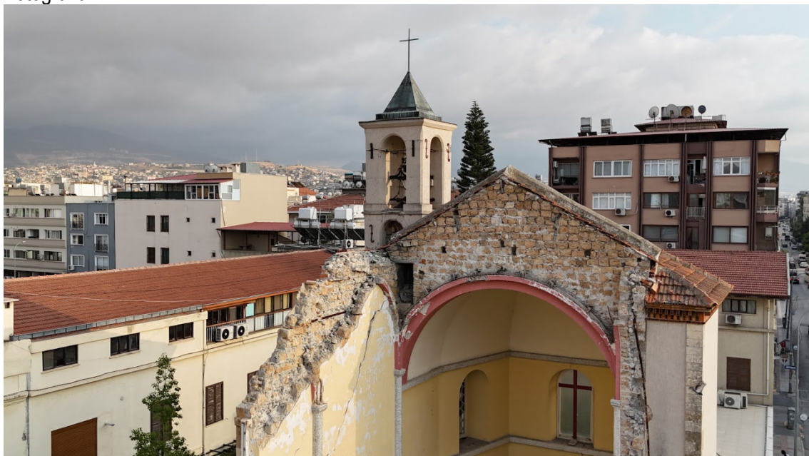
Orázok 1. Celkový pohľad na poškodenie historickej stavby spôsobené zemetrasením s vyznačením oblastí, ktoré sú nebezpečné pre priamu vizuálnu kontrolu.
