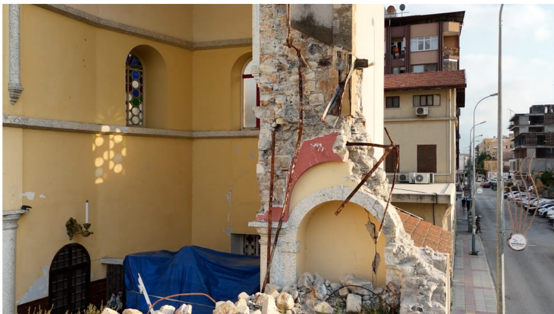
Obrázok 7. Pohľad zobrazujúci viditeľné poškodenia historickej stavby spôsobené zemetrasením vrátane posunutých stavebných prvkov a nestabilných povrchových častí.
