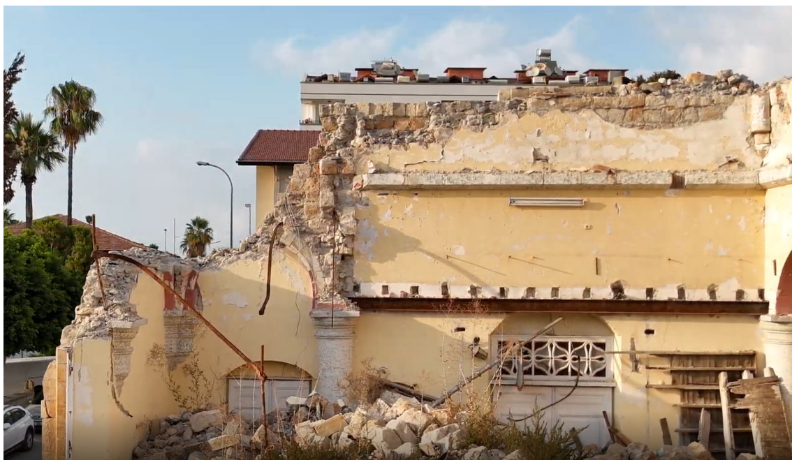
Obrázok 6. Detailný pohľad na viditeľné poškodenie historickej stavby spôsobené zemetrasením.
