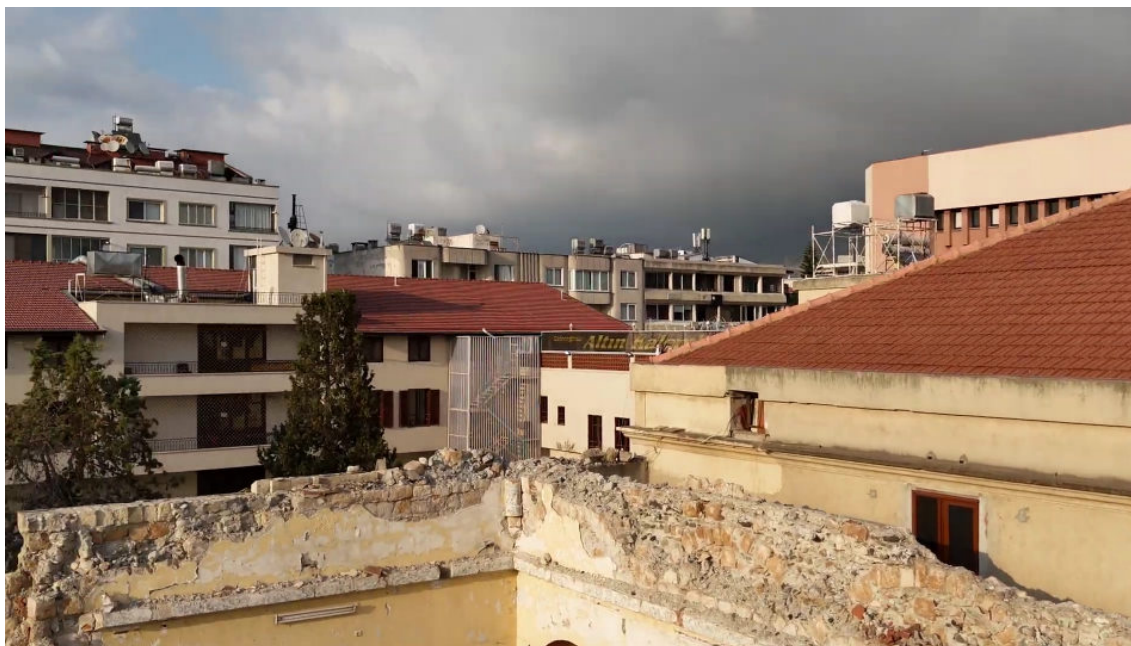
Obrázok 3. Kontextový pohľad zobrazujúci vzťah medzi historickou stavbou poškodenou zemetrasením a okolitou zástavbou.
