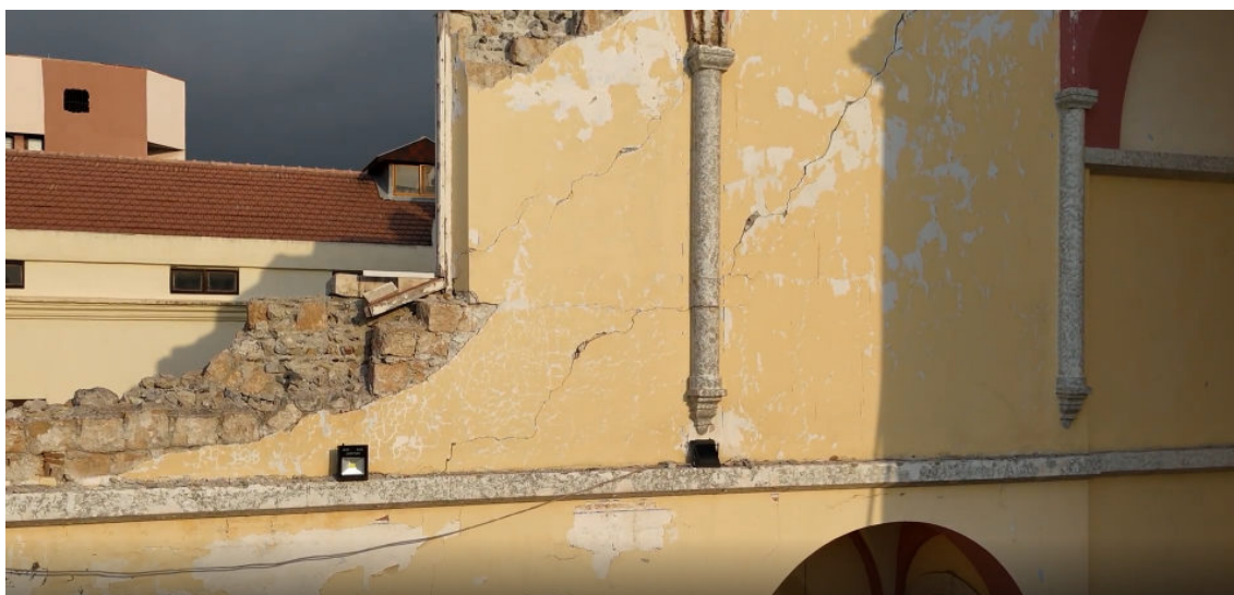
Obrázok 5. Viditeľné trhliny spôsobené zemetrasením na stenách historickej stavby ilustrujúce typické prejavy poškodenia identifikované počas vizuálnej kontroly.
