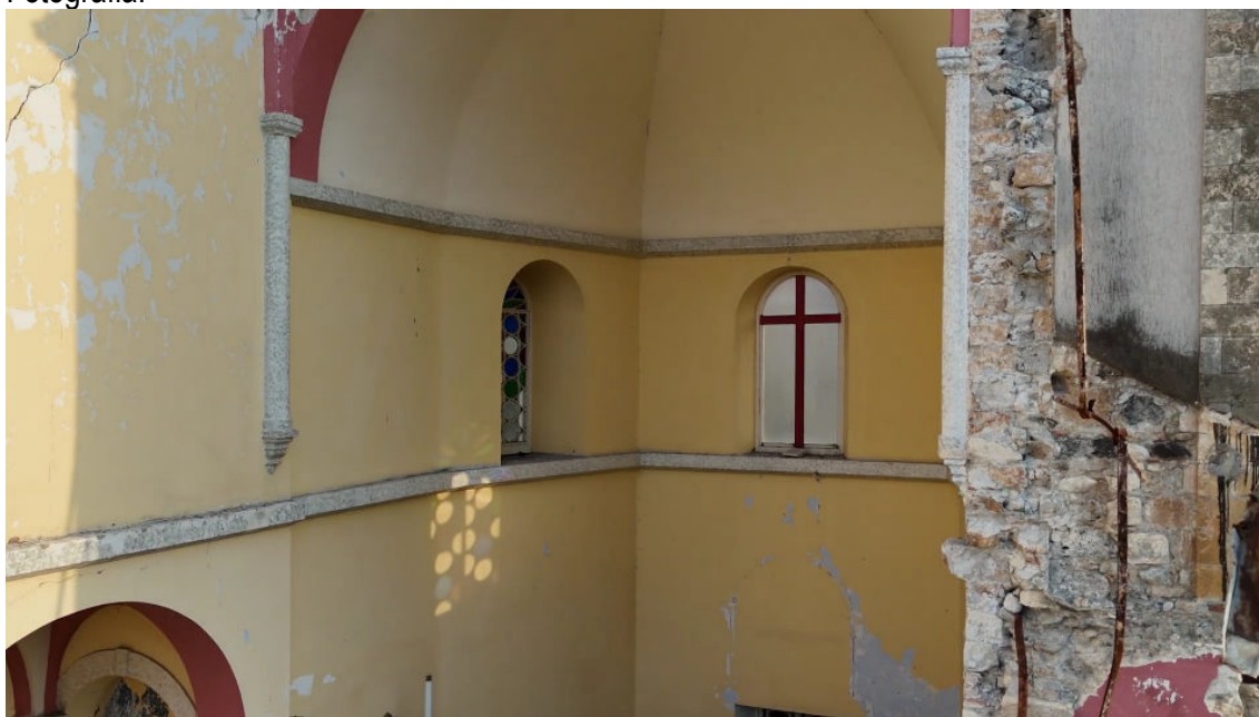
Obrázok 4. Pohľad do interiéru zobrazujúci viditeľné poškodenia spôsobené zemetrasením na povrchoch a dekoratívnych prvkoch historickej stavby.
