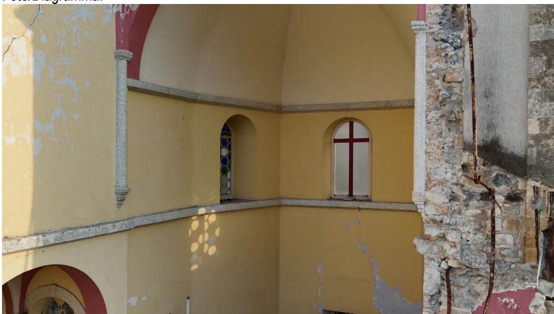
Figura 4. Vista interna che mostra i danni visibili causati dal terremoto su superfici e aree decorative di una struttura storica.
