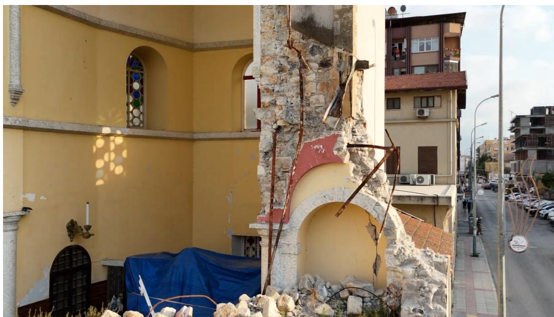
Figura 7. Immagine che mostra i danni visibili causati dal terremoto su una struttura storica, con elementi dislocati e aree superficiali instabili.
