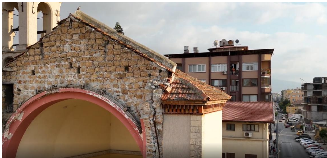
Figura 12. Immagine ripresa da un drone durante l'ispezione finale, che mostra l'instabilità causata dal terremoto nelle parti superiori di una struttura storica.
