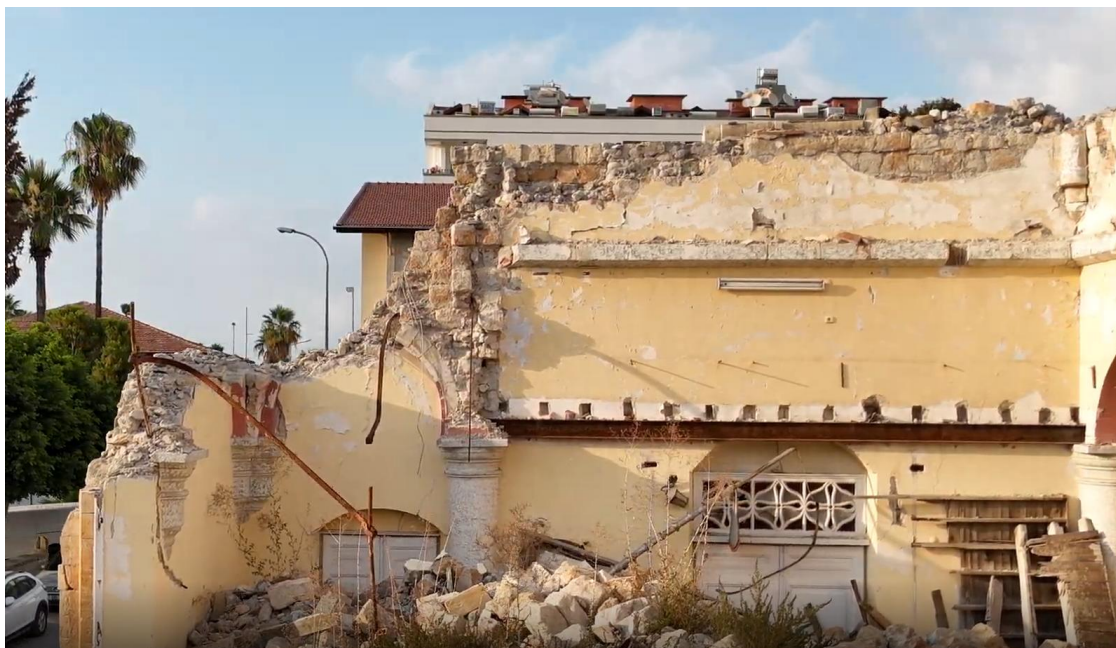
Figura 6. Vista ravvicinata che mostra i danni visibili causati dal terremoto su una struttura storica, evidenziando le aree di distacco e le crepe superficiali.
