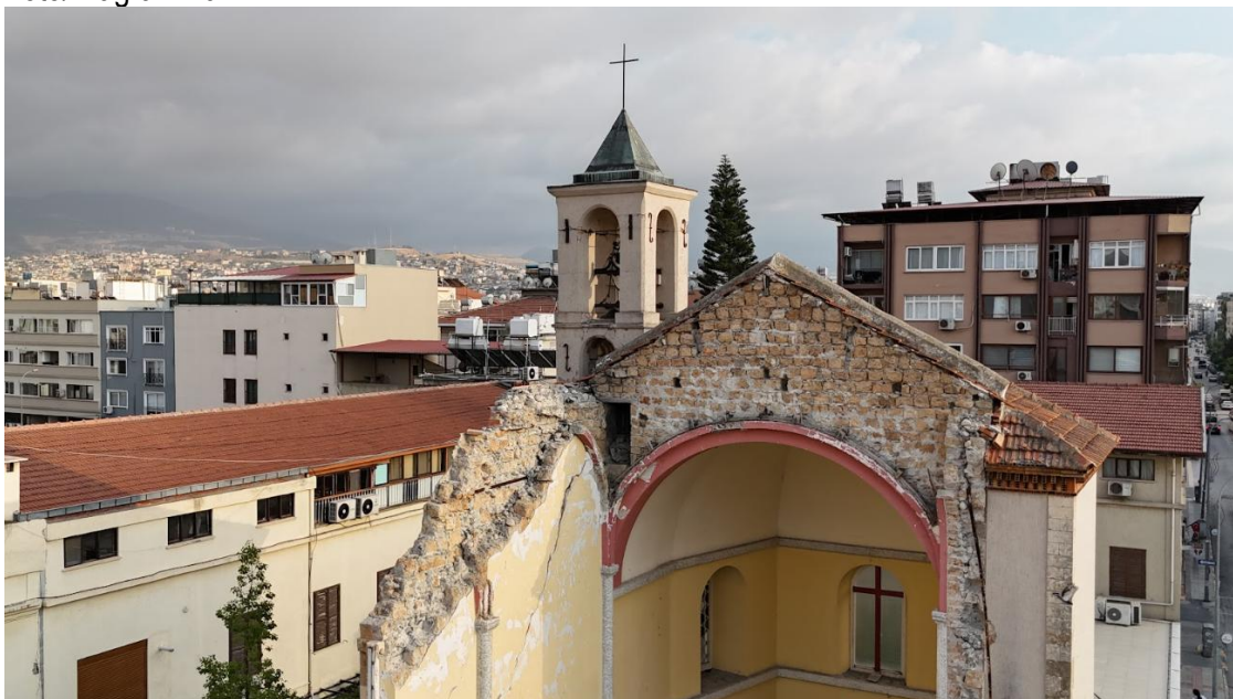
Figura 1. Vista generale dei danni causati dal terremoto a una struttura storica, con evidenziazione delle aree non sicure per l'ispezione diretta.
