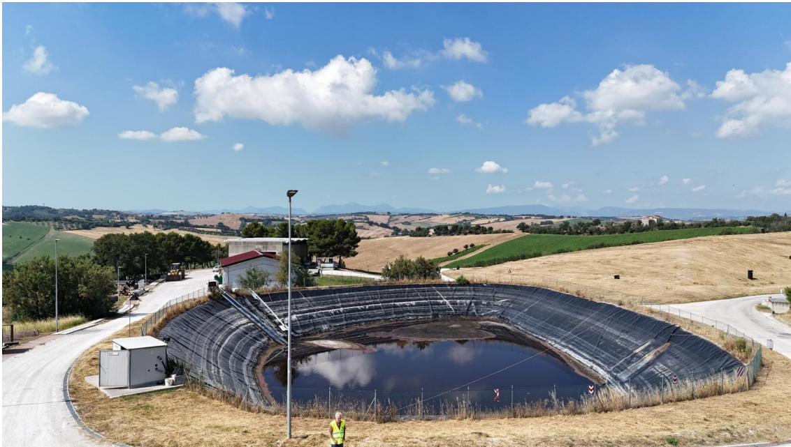
Nádrž priesakových vôd (pozorovací bod 3)
